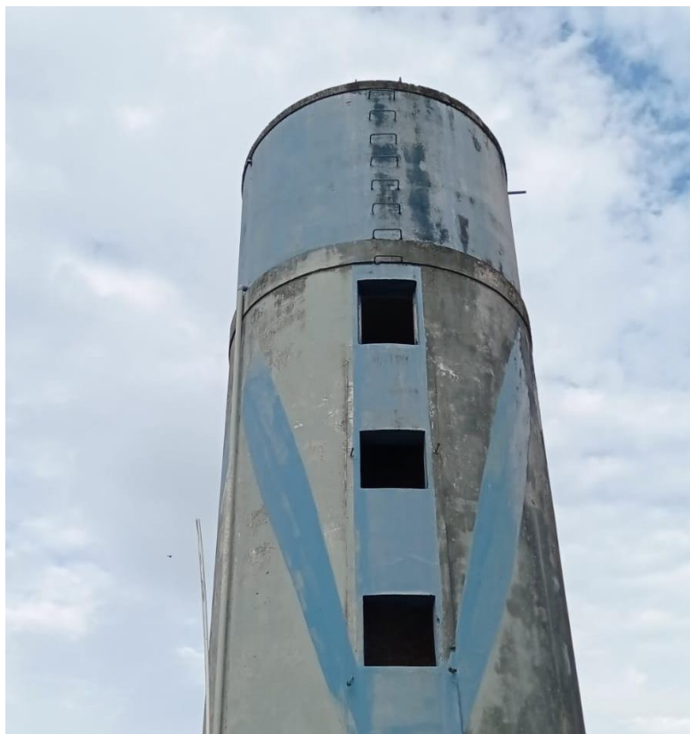
Figura 25 - Castelo d'água desativado utilizado como reservatório no projeto de hidrantes
