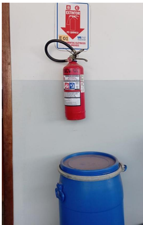
Figura 23 - Extintor do laboratório de solos (Bloco E)
