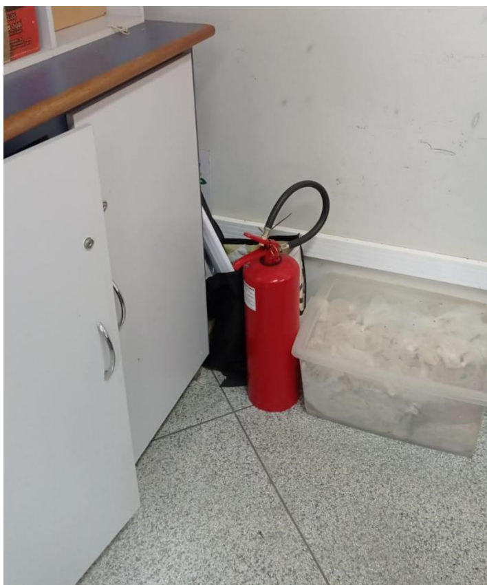
Figura 21 - Extintor no chão sem sinalização
