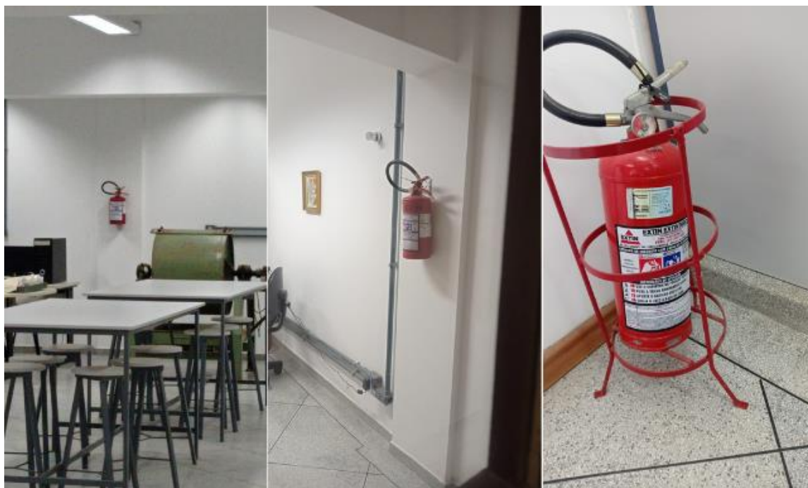
Figura 22 - Extintores do laboratório de pavimentação (Bloco E)
