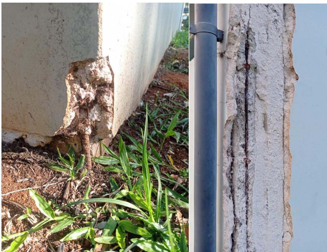
Figura 11- Exposição de armaduras em estruturas de concreto armado
