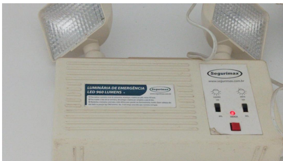
Figura 17 - Bloco autônomo de emergência existente
