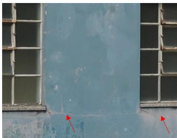
Figura 73: Fissura em canto de esquadria – Fachada H
