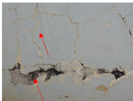
Figura 19: Bolor e fissura mapeada
