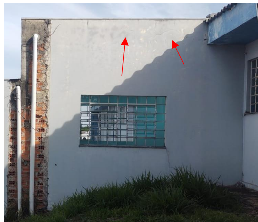
Figura 154: Infiltração e eflorescência – Fachada A
