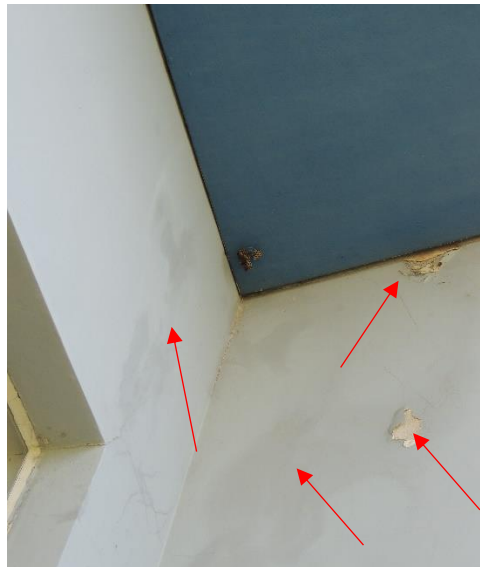
Figura 44: Infiltração e descamação do revestimento
