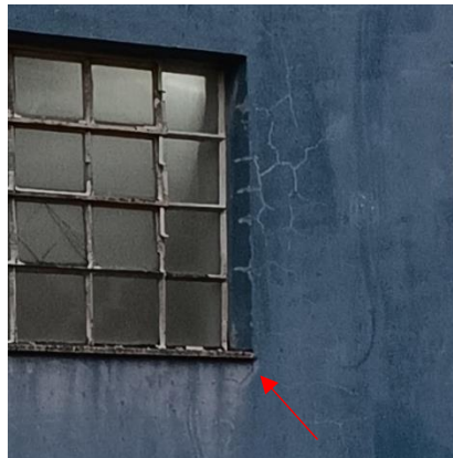
Figura 98: Fissura no canto da esquadria – Fachada K
