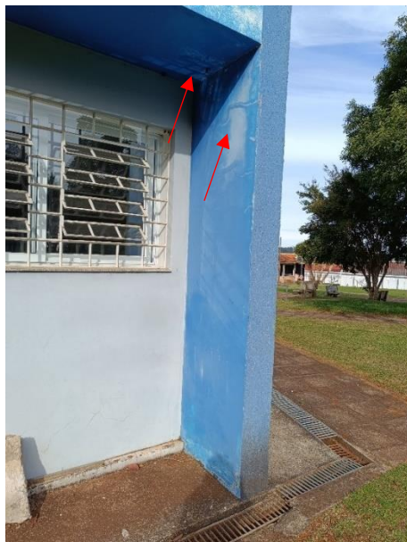
Figura 171: Eflorescência e infiltração - Fachada E
