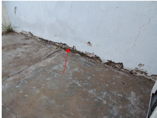
Figura 51: Bolor no revestimento
