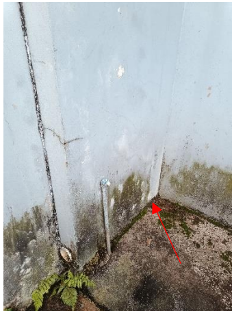
Figura 95: Bolor – Fachada J
