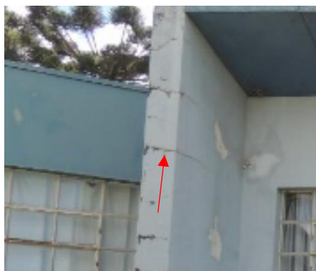
Figura 54: Fissuras horizontais sem causa bem definida
