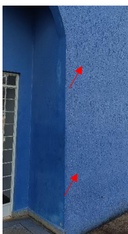
Figura 175: Eflorescência - Fachada F
