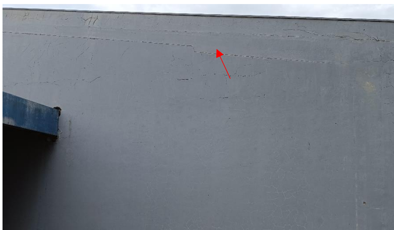
Figura 72: Fissura entre estrutura e alvenaria na fachada H
