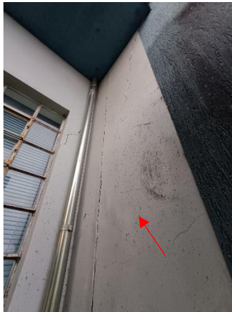
Figura 105: Fissura entre estrutura e alvenaria – Fachada L
