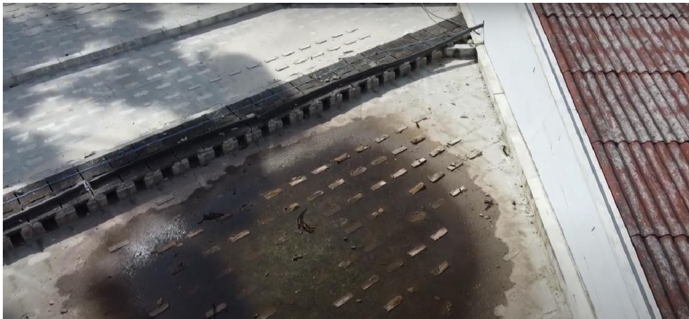
Figura 190: Poças de água na cobertura - Etapa 1
