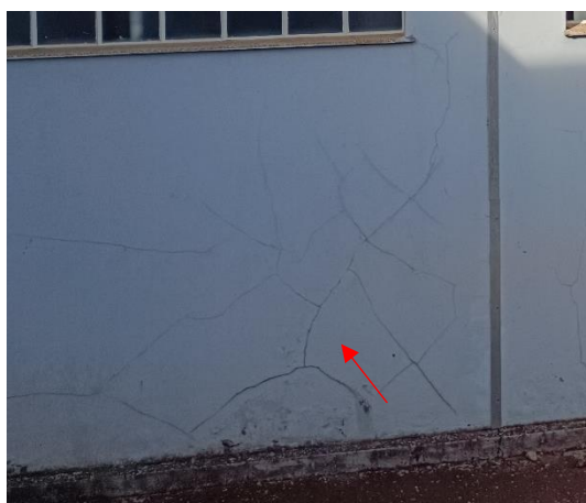
Figura 136: Fissuras mapeadas - Fachada E
