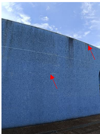
Figura 174: Fissuras mapeadas e bolor - Fachada F
