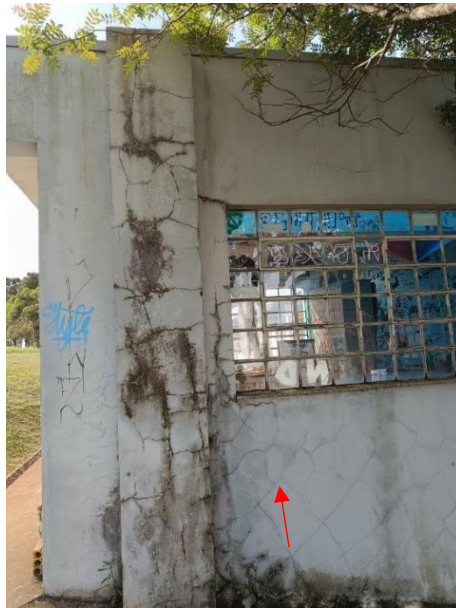
Figura 169; Fissuras mapeadas - Fachada E
