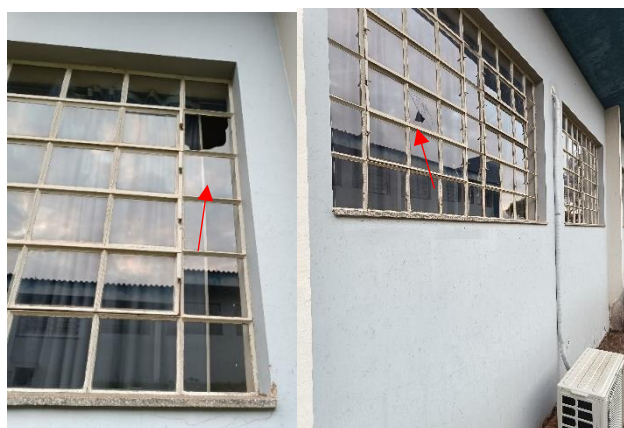
Figura 97: Vidros quebrados nas janelas – Fachada J
