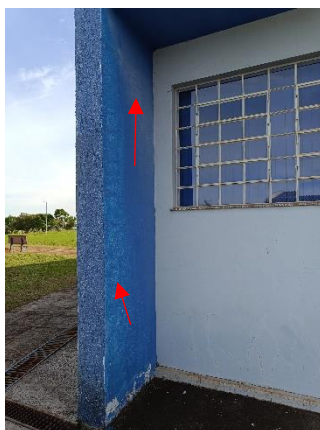
Figura 179: Eflorescência - Fachada G
