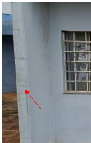
Figura 84: Fissura horizontal sem causa definida – Fachada I
