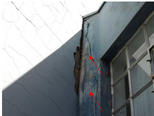
Figura 45: Fissura e eflorescência na fachada D
