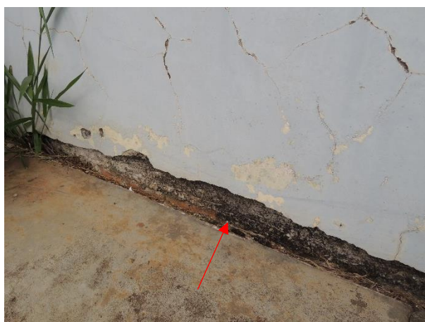
Figura 67: Bolor na fachada G
