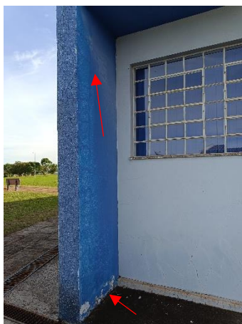
Figura 145: Eflorescência e descamação do revestimento – Fachada G
