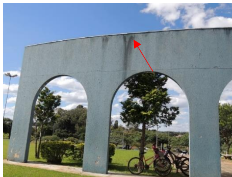
Figura 34: Bolor na fachada C
