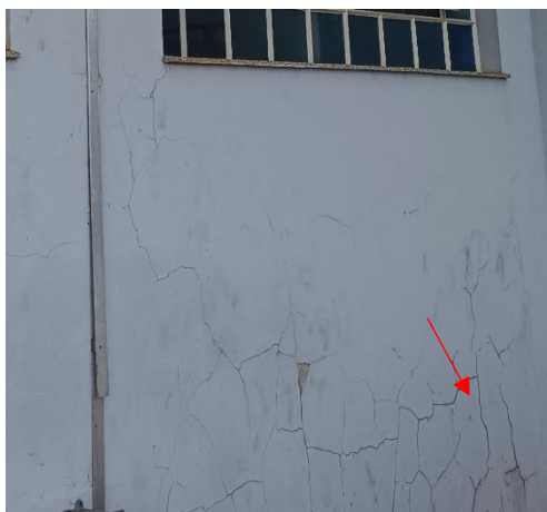
Figura 144: Fissuras mapeadas – Fachada G
