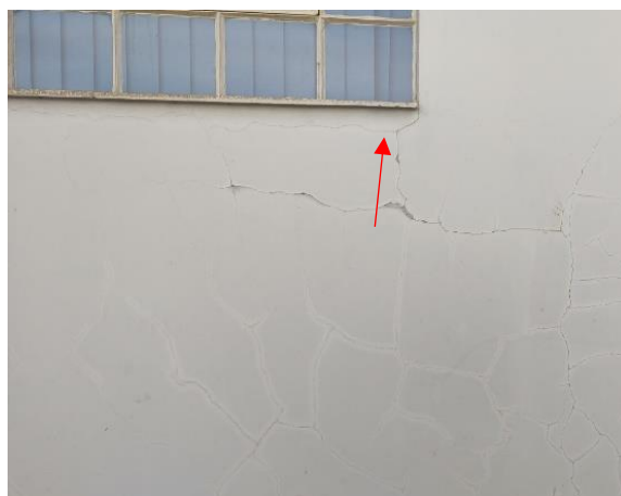
Figura 157: Fissura em canto de esquadria – Fachada B
