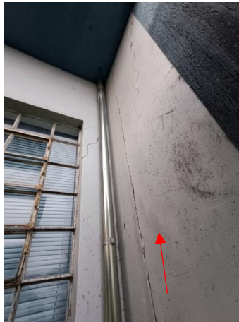
Figura 107: Bolhas no revestimento – Fachada L
