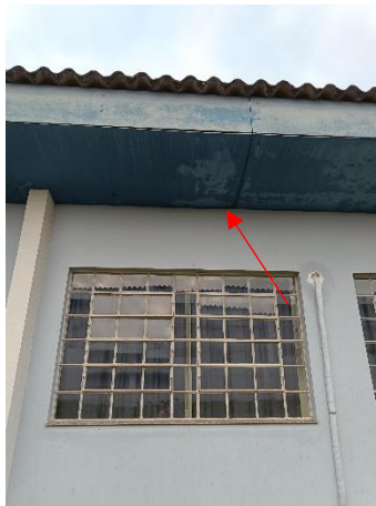
Figura 96: Infiltração – Fachada J
