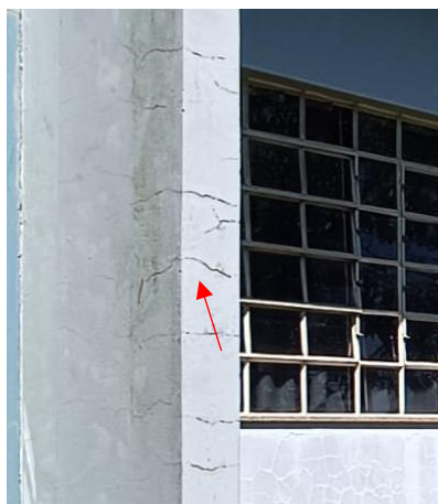
Figura 28: Fissuras na fachada B
