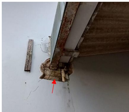
Figura 104: Anomalias sem causa diagnosticada – Fachada K
