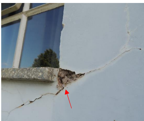
Figura 31: Fissura na quina da janela na fachada B
