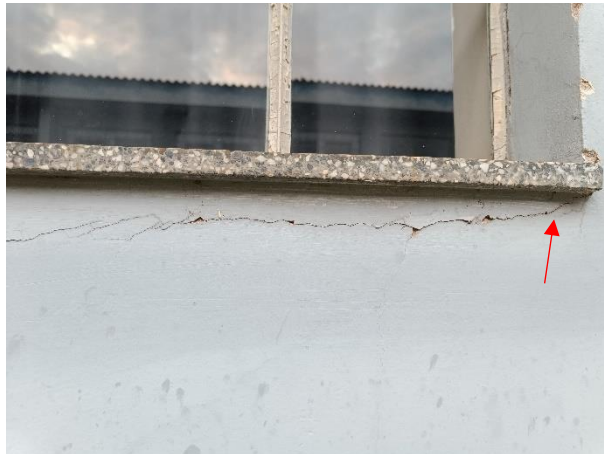
Figura 91: Fissura em quina de esquadria – exemplo 2
