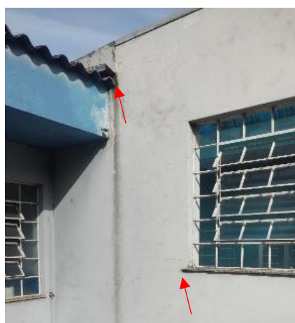
Figura 152: Fissura em canto de esquadria e calha com caimento na alvenaria – Fachada A
