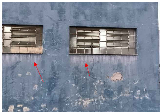
Figura 101: Eflorescência embaixo das esquadrias – Fachada K
