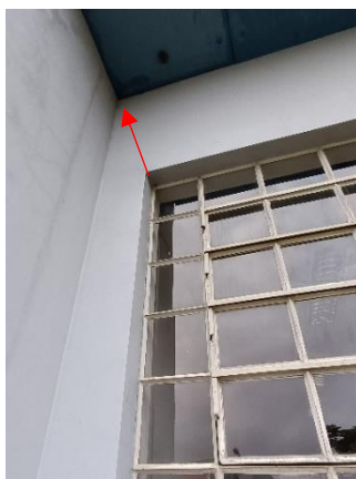
Figura 109: Infiltração – Fachada L
