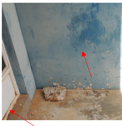
Figura 59: Eflorescência e corrosão em porta na fachada F
