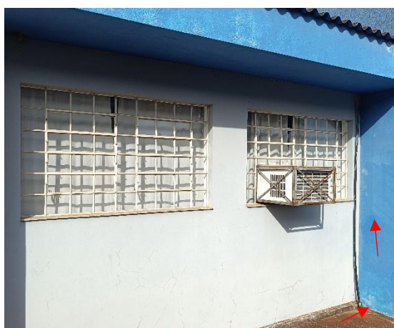
Figura 137: Eflorescência - Fachada E
