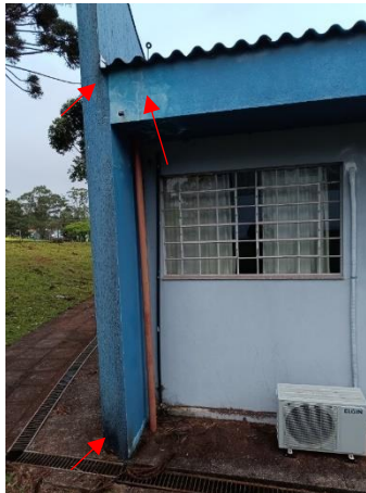
Figura 133: Bolor e eflorescência – Fachada D
