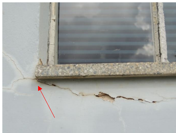
Figura 14: Fissura no canto da esquadria
