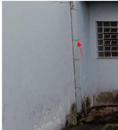
Figura 93: Fissuras sem causa definida pela autora – Fachada J
