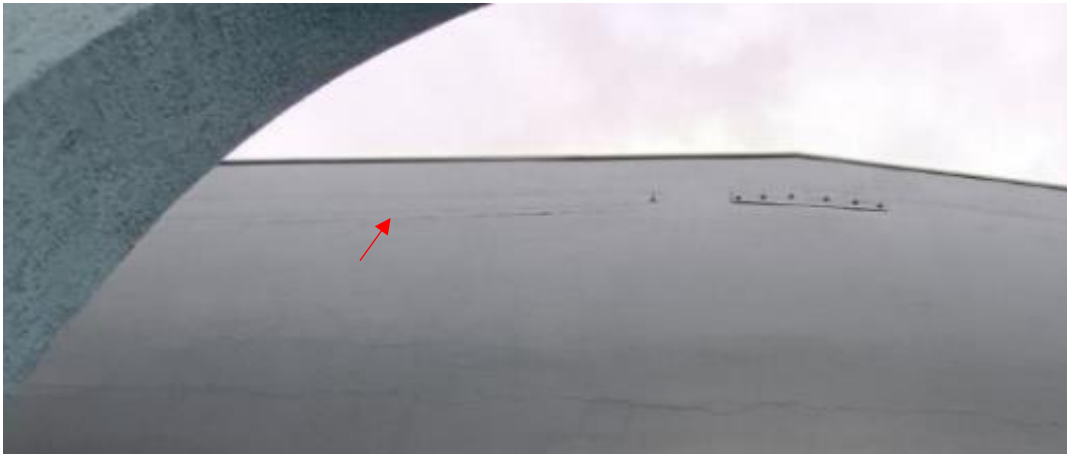
Figura 112: Fissura entre estrutura e alvenaria – Fachada M
