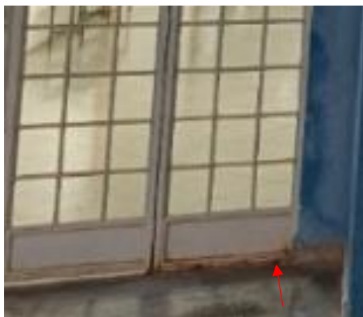
Figura 128: Corrosão da porta metálica – Fachada C
