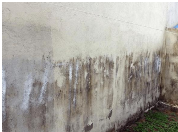
Figura 2: Bolor em fachada
