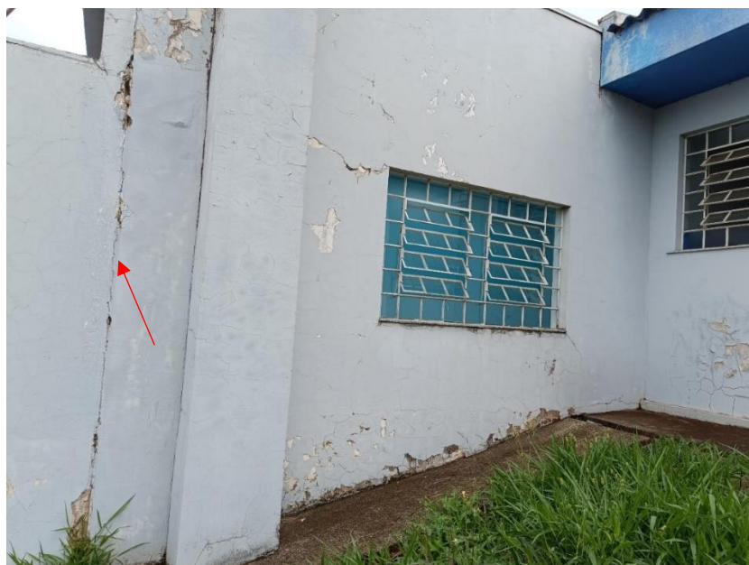
Figura 117: Fissura entre estrutura e alvenaria – Fachada A
