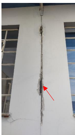
Figura 156; Fissura por falta de junta de dilatação – Fachada B
