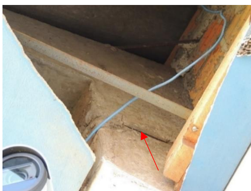
Figura 48: Fissura em elemento estrutural
