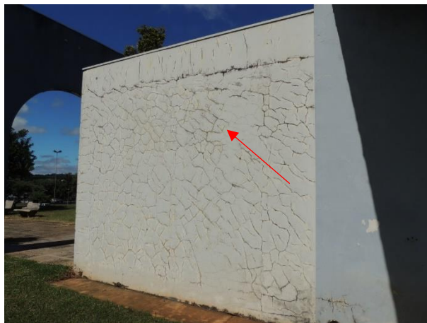
Figura 42: Fissuras mapeadas na fachada D
