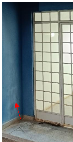
Figura 127: Eflorescência – Fachada C
