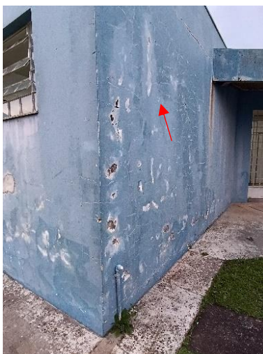
Figura 100: Descamação de revestimento – Fachada K
