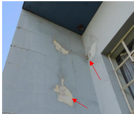
Figura 52: Ponto com infiltração e descamação do revestimento
