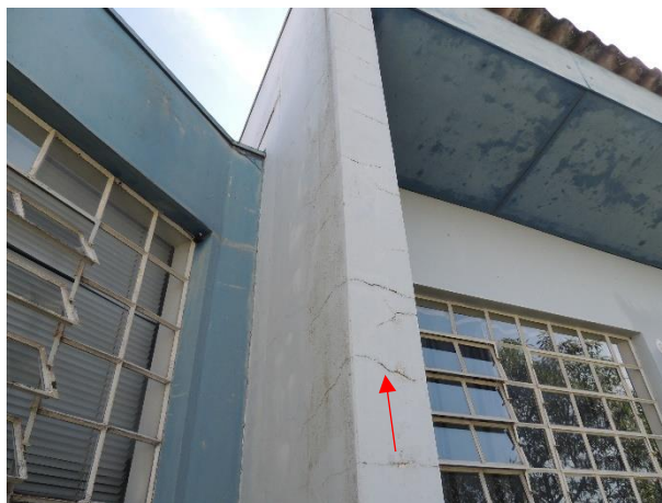
Figura 24: Fissura horizontal sem causa diagnosticada
