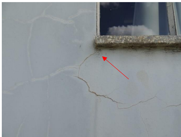
Figura 39: Fissura no canto da janela na fachada D
