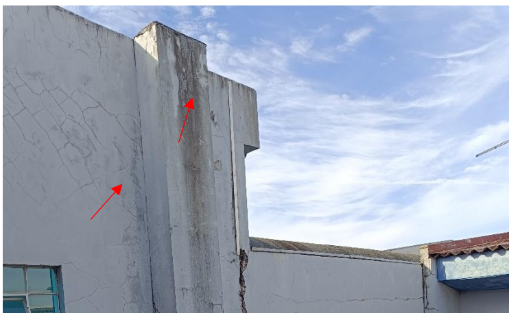
Figura 149: Infiltração e bolor – Fachada H
