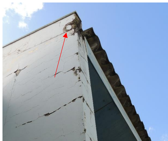
Figura 41: Calha com caimento da fachada D.
