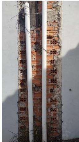
Figura 153: Alvenaria exposta – Fachada A
