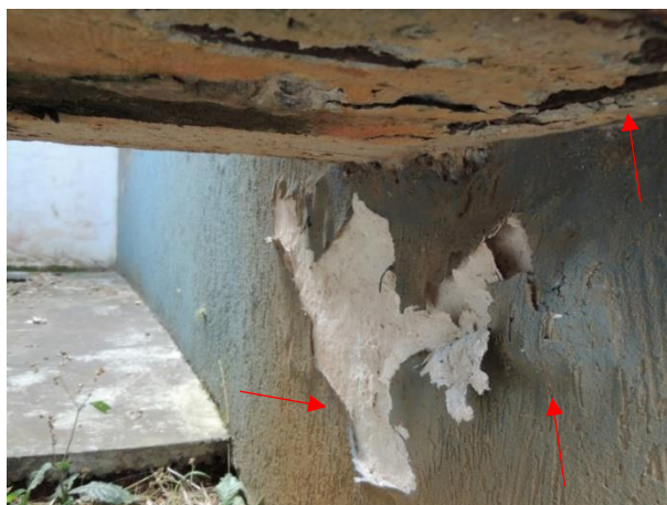
Figura 56: Anomalias na floreira da fachada F
