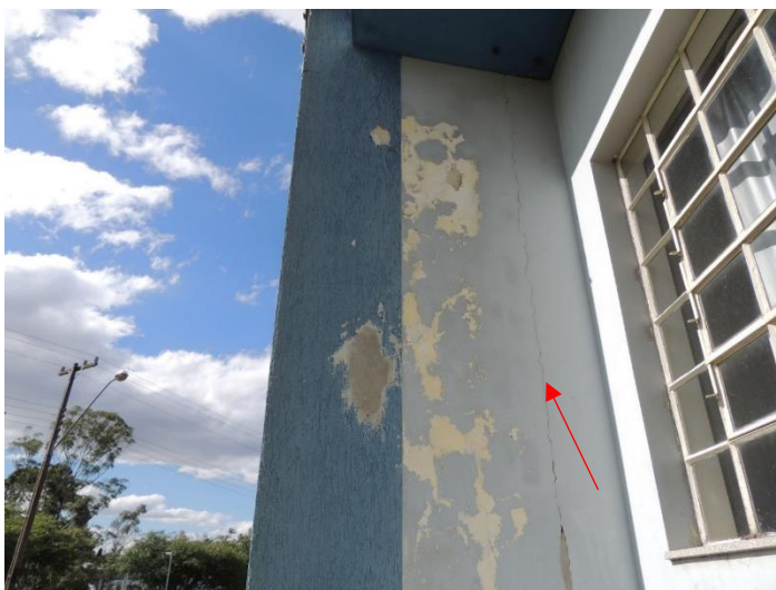
Figura 62: Fissura entre sistema estrutural e de alvenaria
