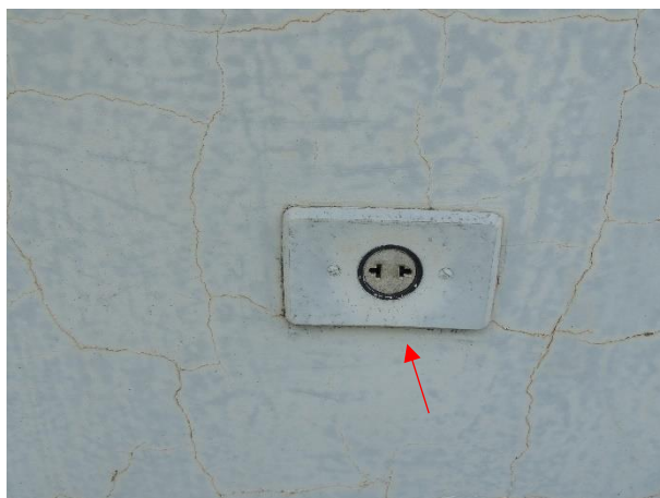
Figura 30: Tomada na fachada B
