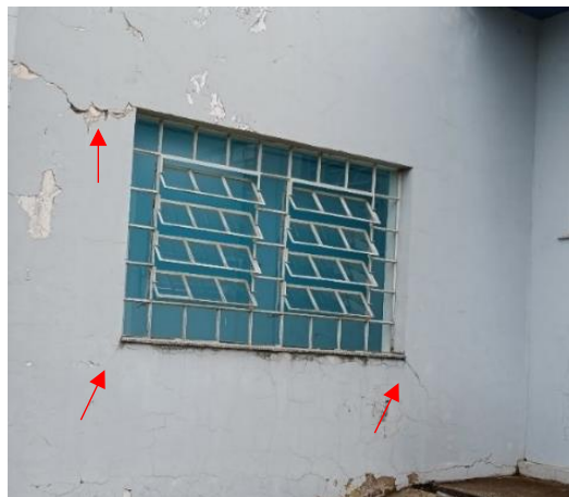
Figura 116: Fissuras nos cantos da janela – Fachada A
