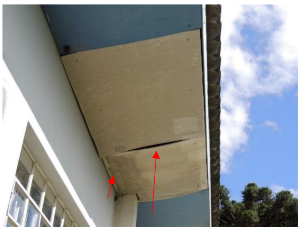
Figura 68: Forro estufado na fachada G
