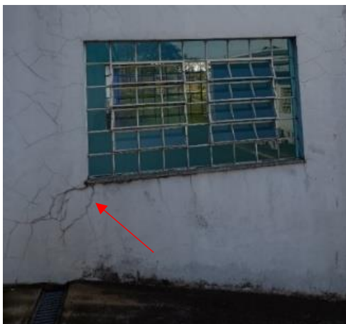
Figura 146: Fissura em canto de esquadria – Fachada H
