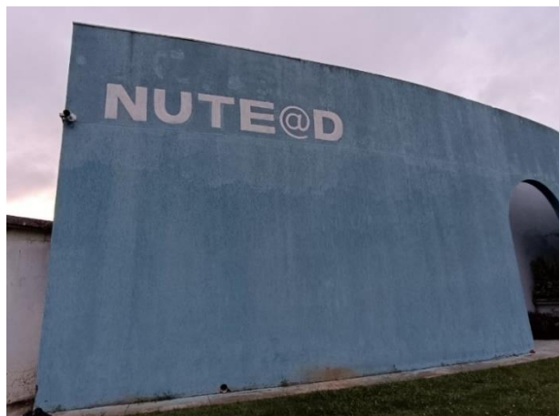
Figura 113: Eflorescência – Fachada M
