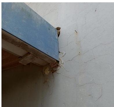
Figura 75: Fissuras mapeadas na fachada H
