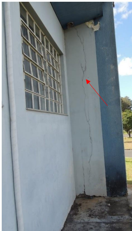
Figura 50: Fissura entre estrutura e alvenaria
