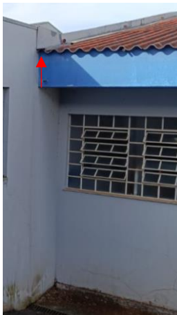
Figura 182: Cobertura sem calha - Fachada H
