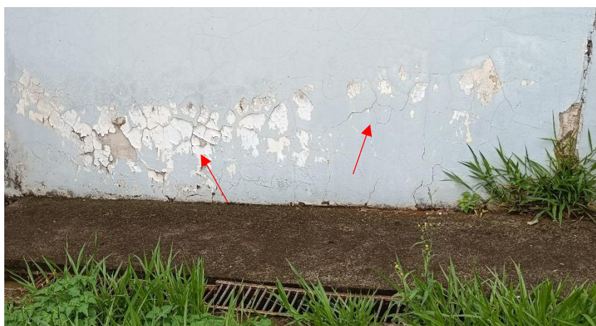
Figura 120: Fissuras mapeadas – Fachada A
