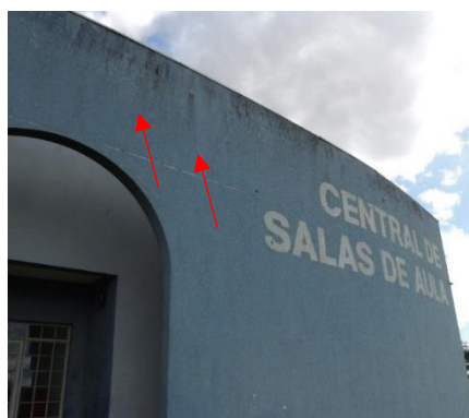
Figura 58: Bolor na fachada F
