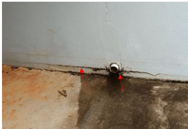
Figura 77: Fissura devido a umidade e bolor – Fachada H
