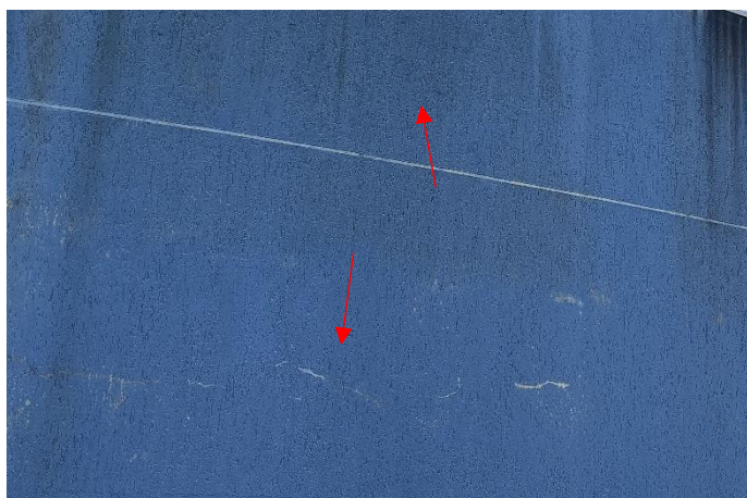
Figura 139: Fissuras mapeadas – Fachada F
