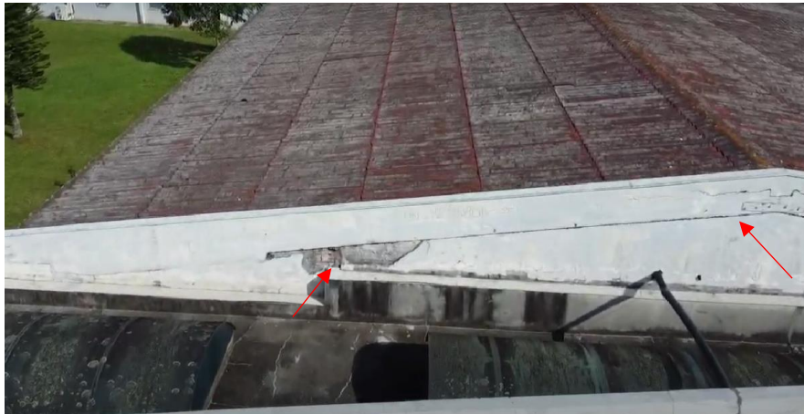
Figura 196: Fissuras e degradação do concreto - Etapa 1 cobertura
