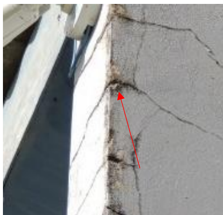
Figura 78: Fissura sem causa diagnosticada na fachada H
