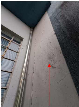
Figura 108: 109: Bolor em ponto na fachada L
