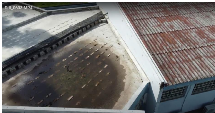
Figura 191: Poça de água - Etapa 1
