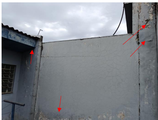
Figura 118: Bolhas, infiltração e descamação do revestimento – Fachada A
