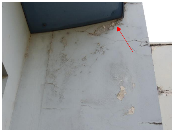
Figura 17: Infiltração na fachada A
