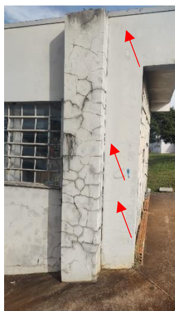
Figura 166: Fissuras mapeadas e bolor - Fachada D
