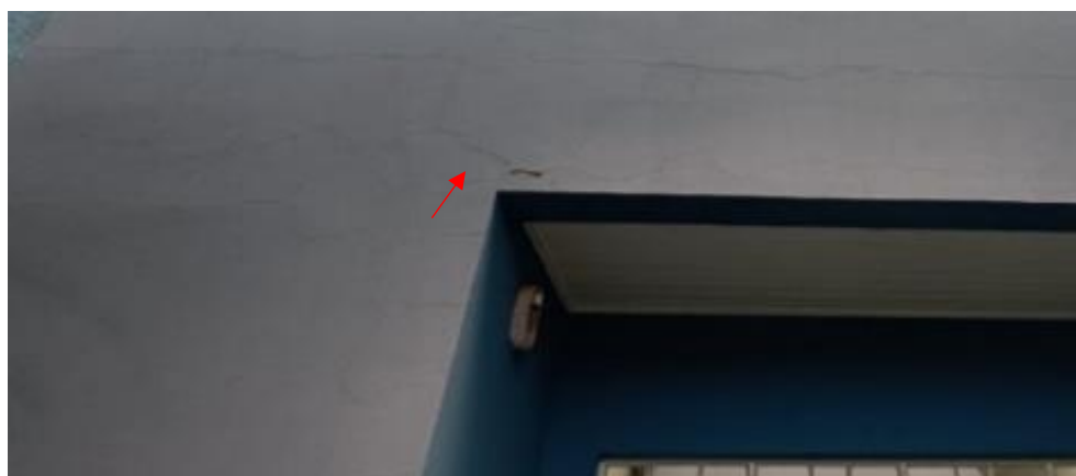
Figura 114: Fissuras mapeadas – Fachada M
