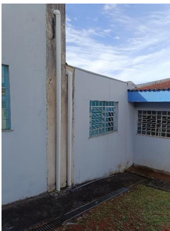
Figura 183: Drenagem de águas pluviais aparente - Fachada H
