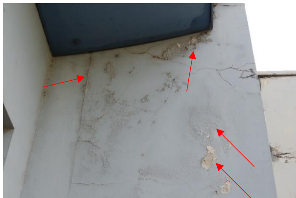
Figura 27: Fissura entre estrutura e alvenaria, infiltração, bolhas e descamação da pintura na fachada B
