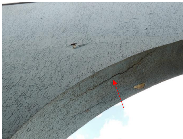
Figura 55: Fissura na estrutura de concreto da fachada F
