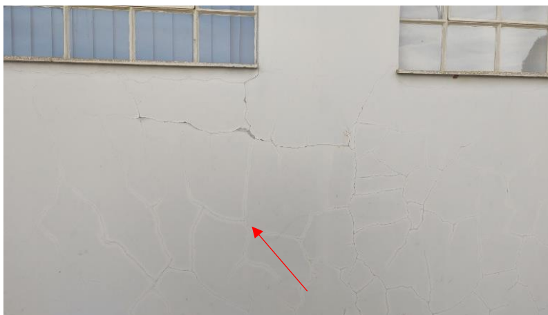
Figura 158: Fissuras mapeadas – Fachada B
