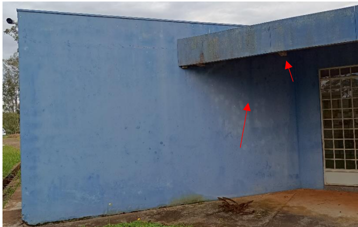
Figura 76: Infiltração e eflorescência – Fachada H
