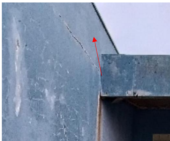
Figura 99: Fissura entre estrutura e alvenaria – Fachada K
