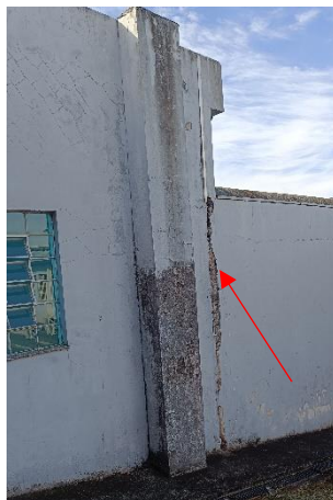
Figura 147: Fissura entre estrutura e alvenaria – Fachada H
