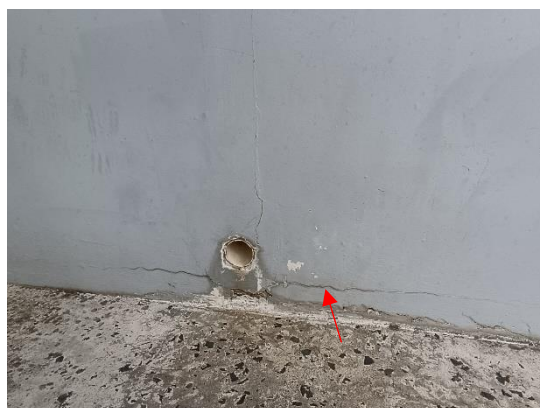
Figura 102: Fissuração por umidade – Fachada K
