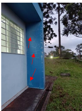
Figura 124: Eflorescência e fissuras mapeadas – Fachada B
