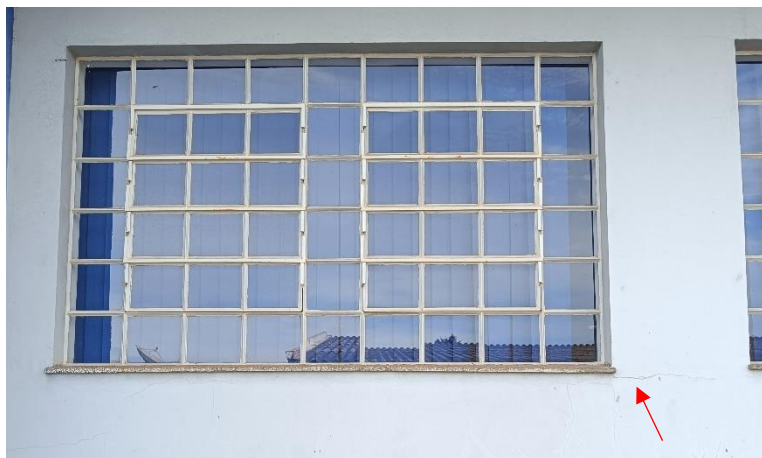
Figura 142: Fissura em canto de esquadria – Fachada G
