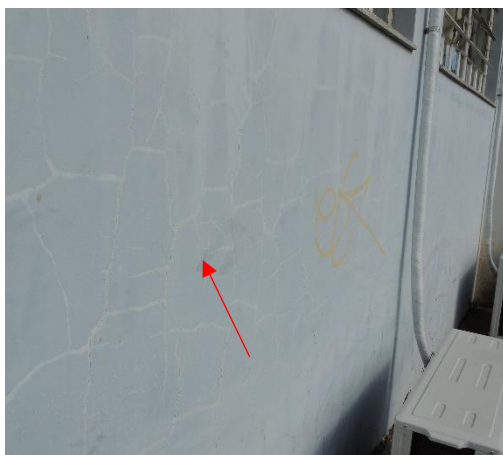
Figura 63: Fissuras mapeadas da fachada G
