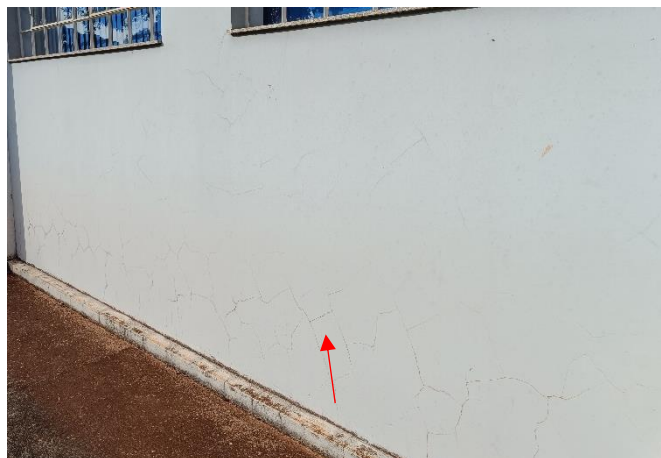
Figura 170: Início de fissuras mapeadas - Fachada E
