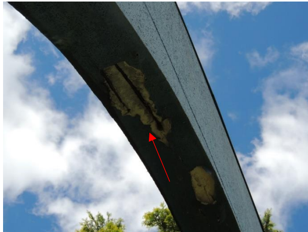
Figura 33: Armaduras aparentes na fachada C
