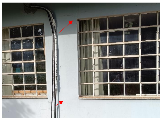
Figura 168: Fissuras em canto de esquadria - Fachada E
