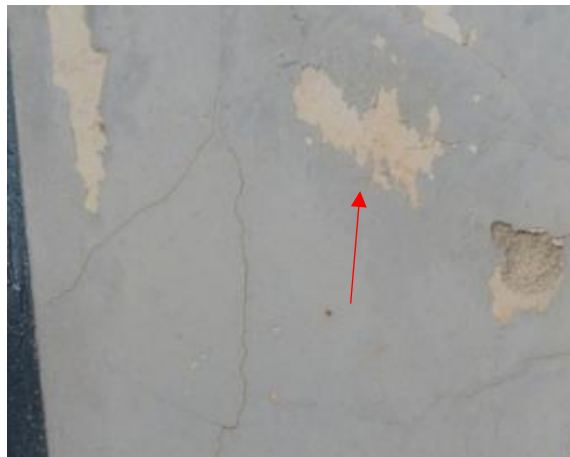
Figura 21: Descamação da pintura do revestimento
