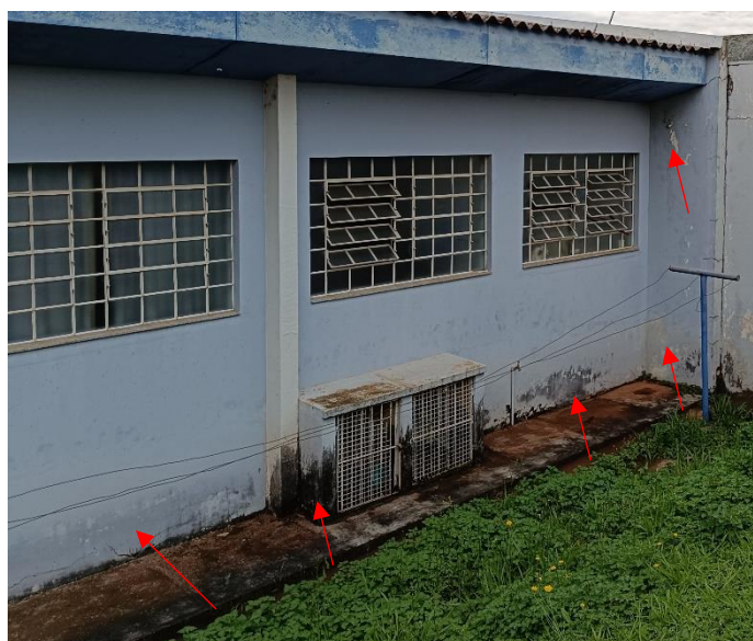
Figura 86: Infiltração e descamação de pintura – Fachada I
