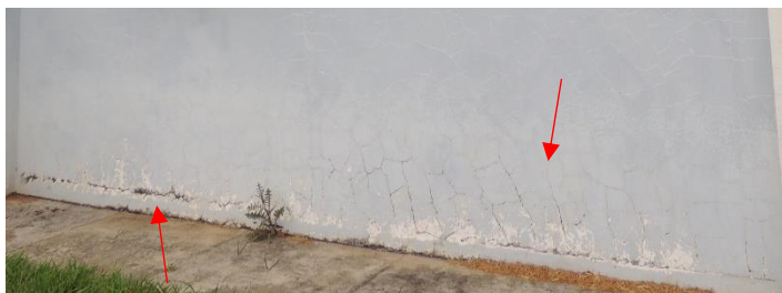
Figura 23: Fissuras na fachada A
