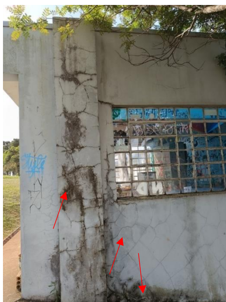
Figura 172: Bolor e umidade - Fachada E
