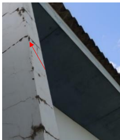
Figura 46: Fissuras sem causa diagnosticada
