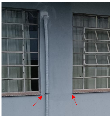
Figura 130: Fissura em canto de janela – Fachada D
