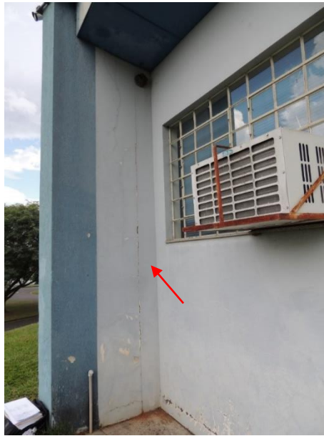
Figura 13: Fissura entre alvenaria e elemento estrutural
