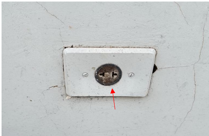
Figura 89: Tomada externa – Fachada J
