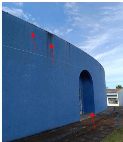
Figura 140: Bolor e eflorescência – Fachada F
