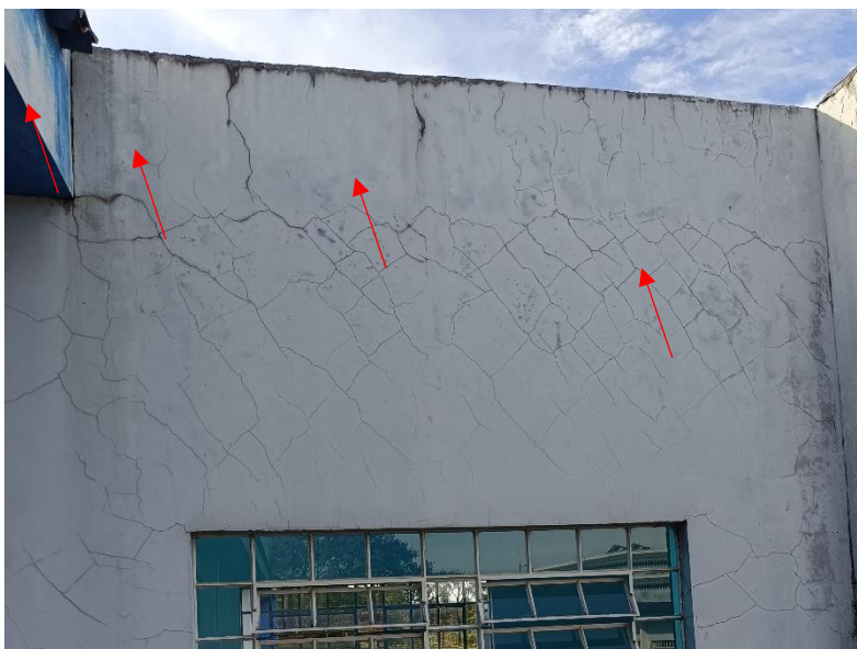
Figura 148: Fissuras mapeadas e eflorescência – Fachada H
