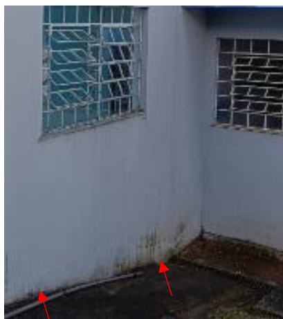
Figura 184: Bolor e descamação da pintura - Fachada H
