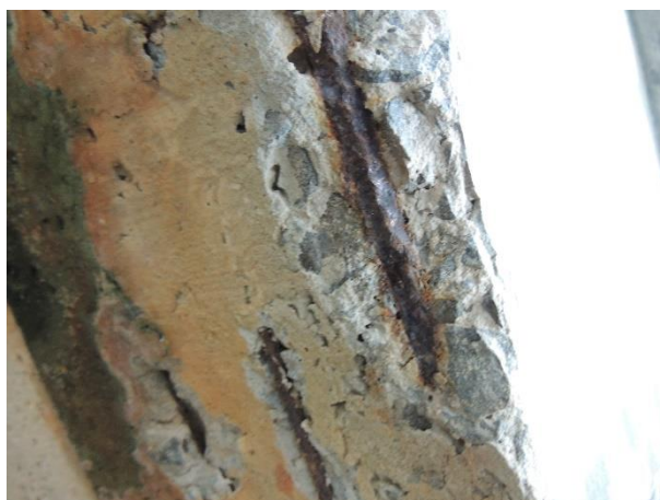
Figura 57: Armadura exposta em floreira na fachada F
