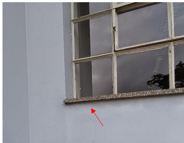
Figura 106: Fissura em quina de esquadria – Fachada L
