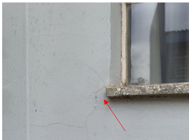
Figura 81: Fissura em canto de esquadria – fachada I
