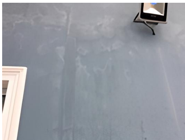
Figura 3: Eflorescência em fachada
