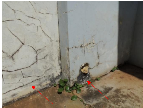
Figura 43: Bolor e fissura devido a umidade
