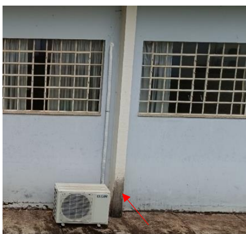
Figura 85: Bolor na fachada I
