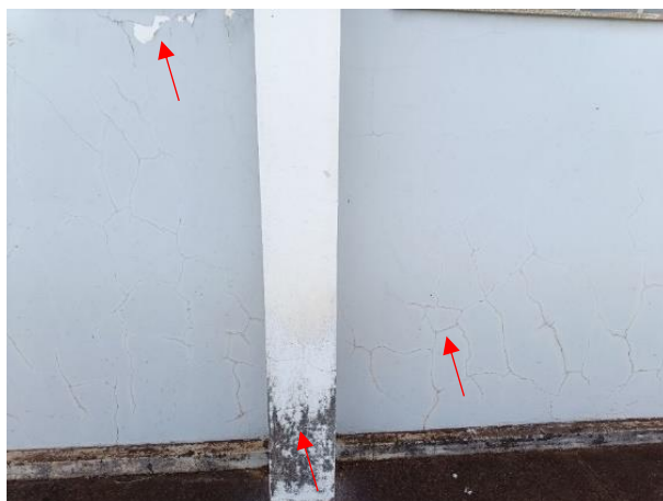
Figura 178: Fissuras mapeadas, bolor e descamação do revestimento - Fachada G
