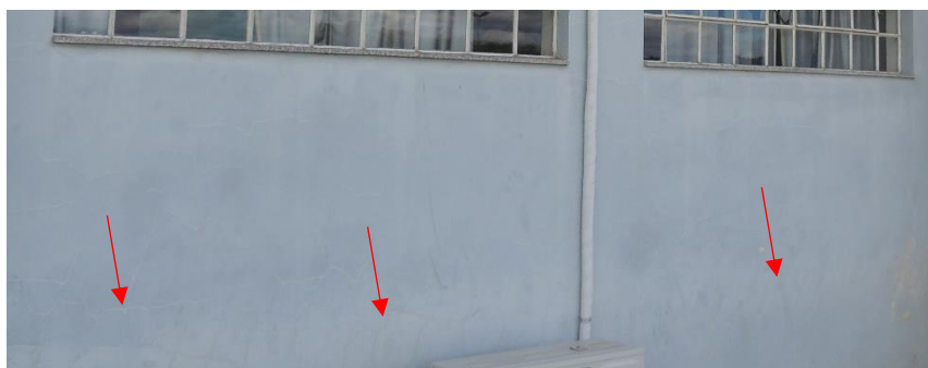
Figura 53: Fissuras mapeadas na fachada E
