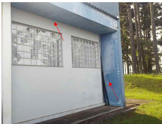
Figura 159: Eflorescência – Fachada B
