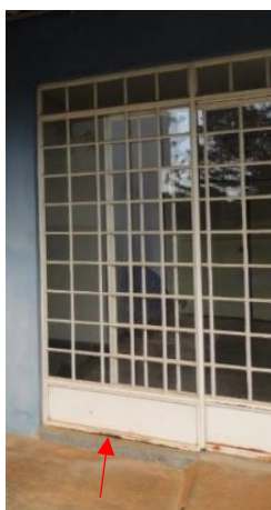
Figura 79: Corrosão em porta na fachada H
