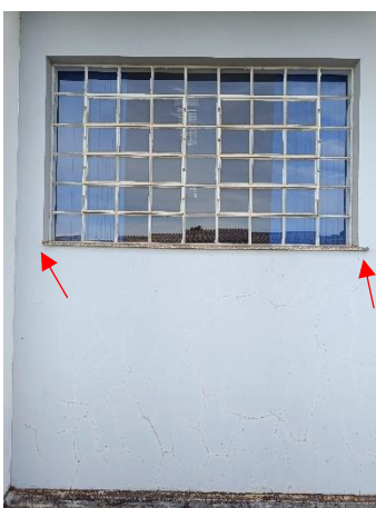
Figura 177: Fissuras em canto de esquadria - Fachada G
