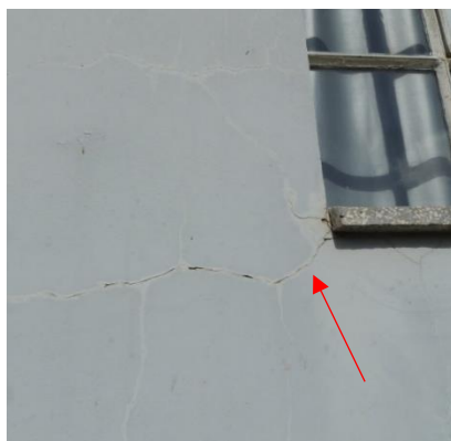
Figura 61: Fissura na quina da janela da fachada G
