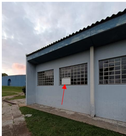
Figura 110: Vidro quebrado – Fachada L
