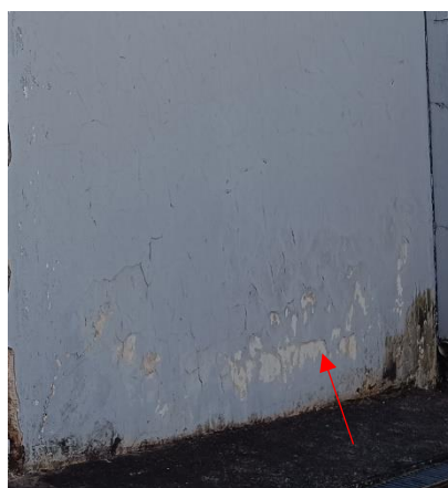
Figura 150: Descamação do revestimento – Fachada H
