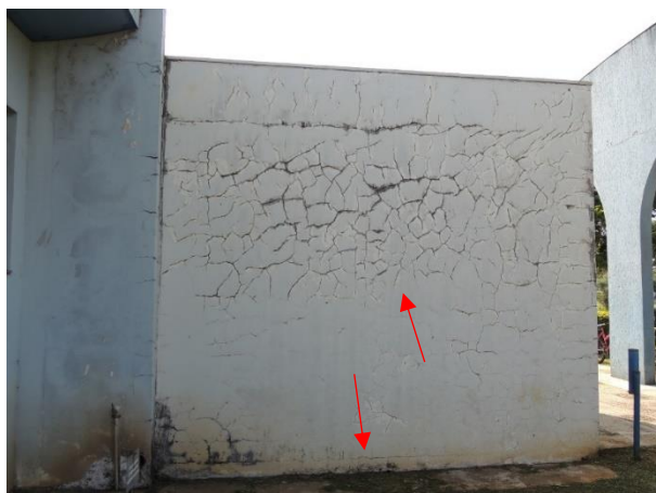
Figura 29: Fissuras mapeadas e devido à umidade na fachada B
