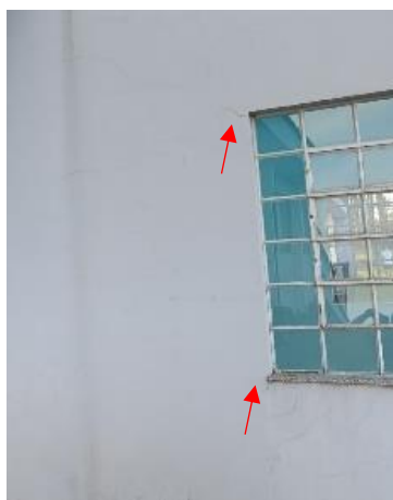
Figura 181: Fissuras em canto de esquadria - Fachada H
