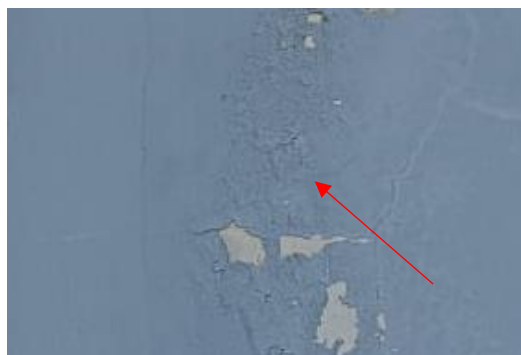
Figura 22: Bolhas no revestimento
