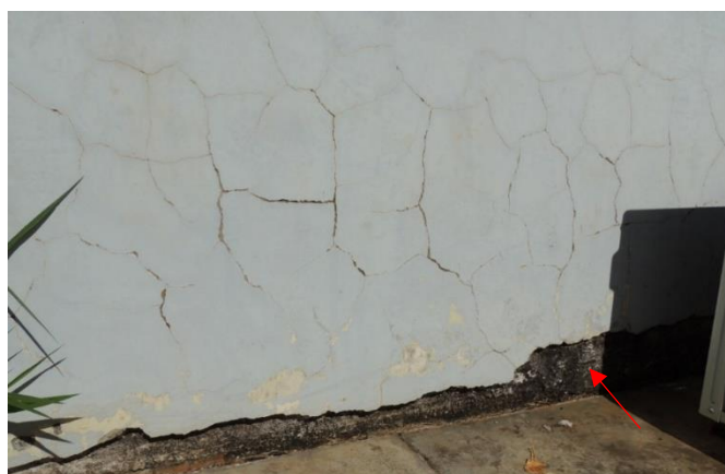
Figura 64: Segundo ponto com fissura mapeada na fachada G
