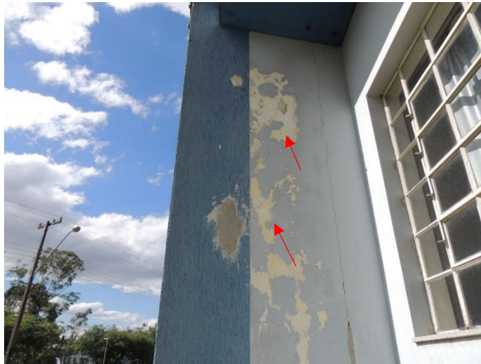
Figura 65: Descamação da pintura na fachada G
