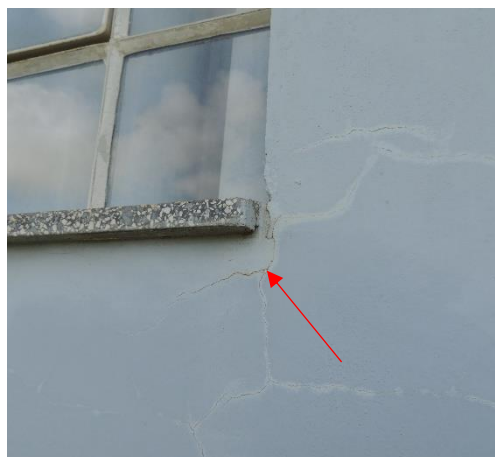
Figura 49: Fissura no canto da janela na fachada E
