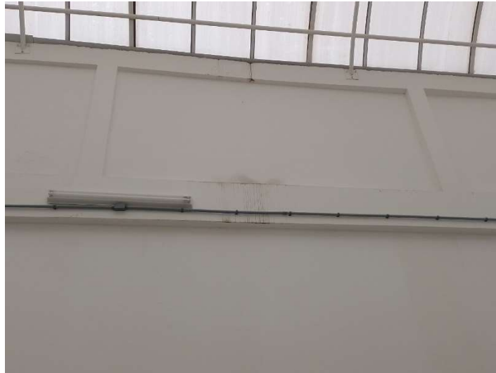
Figura 39 - Mancha de umidade na parede acima da rampa
