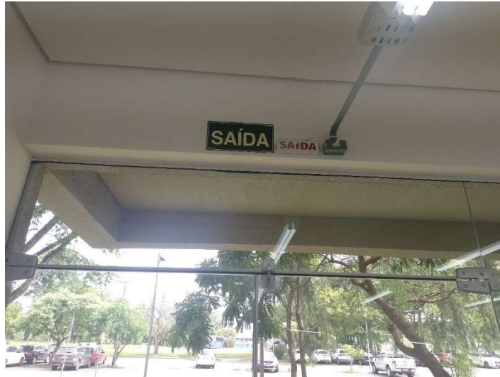
Figura 24 - Sinalização de emergência
