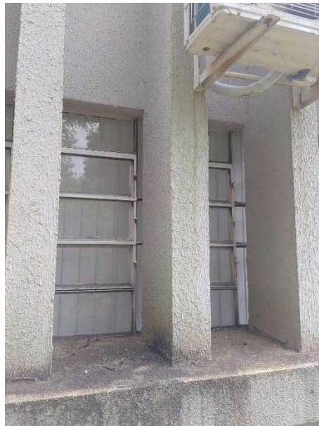
Figura 29 - Acúmulo de sujeira na estrutura
