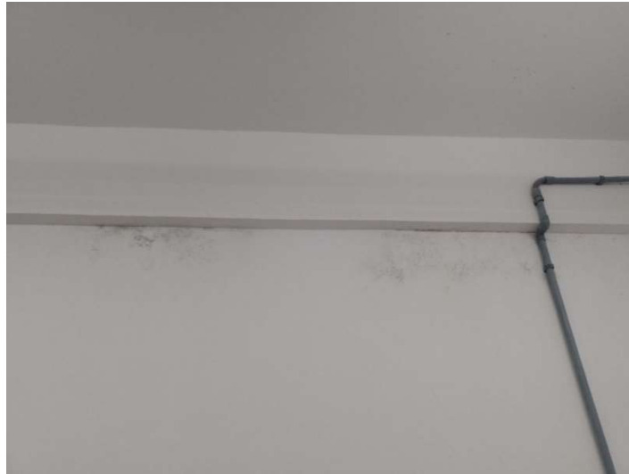
Figura 15 - Manchas de umidade na parede do Lab.1
