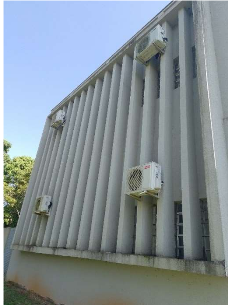
Figura 28 - Manchas de umidade nos fundos da edificação
