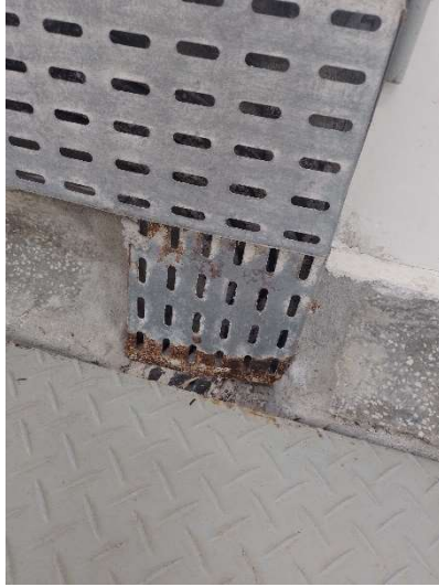
Figura 35 - Corrosão da eletrocalha
