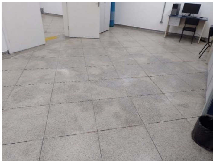
Figura 14 - Manchas de umidade no piso do Lab.1
