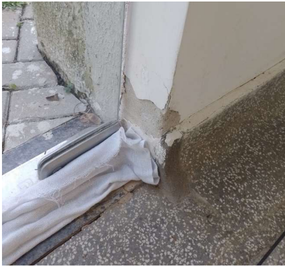
Figura 36 - Descascamento da pintura
