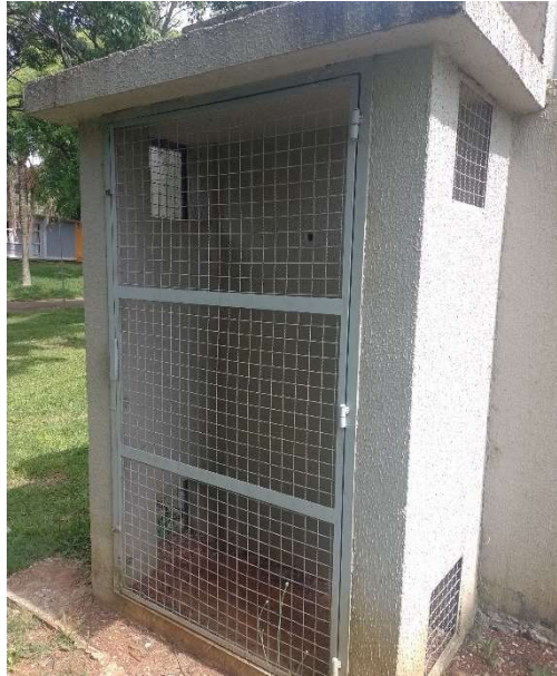
Figura 30 - Central de gás
