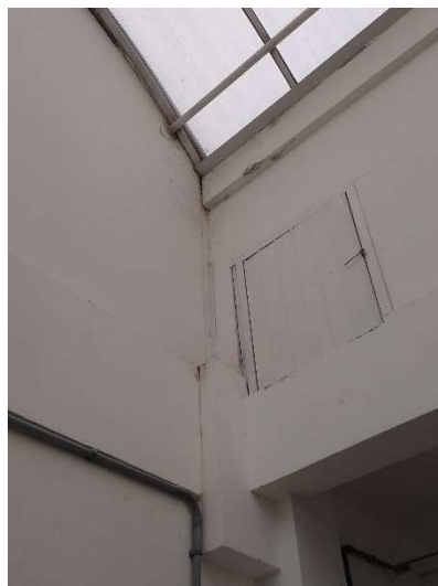
Figura 38 - Mancha de umidade no canto superior do 2º pavimento
