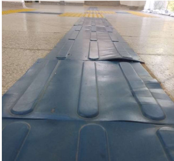
Figura 37 - Descolamento do piso tátil
