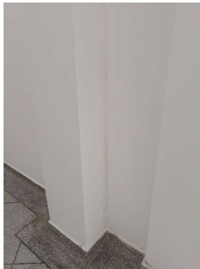
Figura 32 - Fissura entre estrutura e alvenaria
