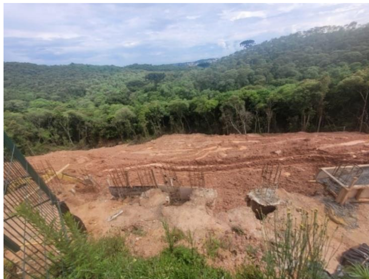
Figura 34 - Talude após ruptura
