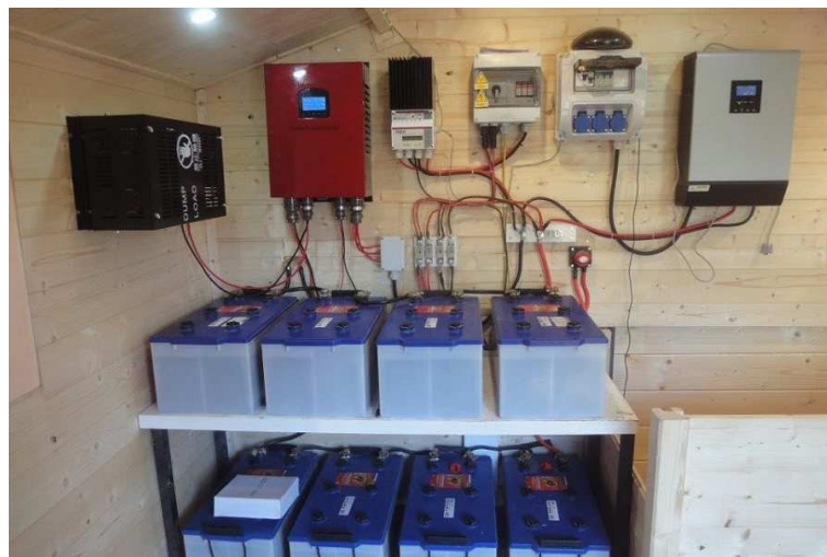
Figura 13 – Banco de baterias de um sistema autônomo
