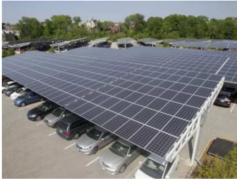
Figura 18 - Estacionamento fotovoltaico da Universidade Federal do Rio de Janeiro
