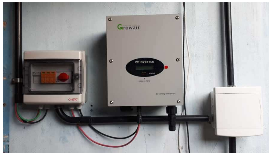
Figura 15 – Inversor e caixa de junção de um sistema conectado à rede
