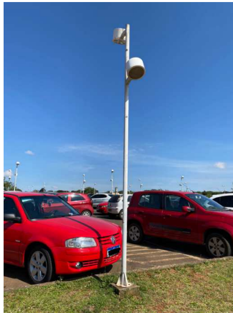
Figura 27 – Exemplo de poste de luz no estacionamento
