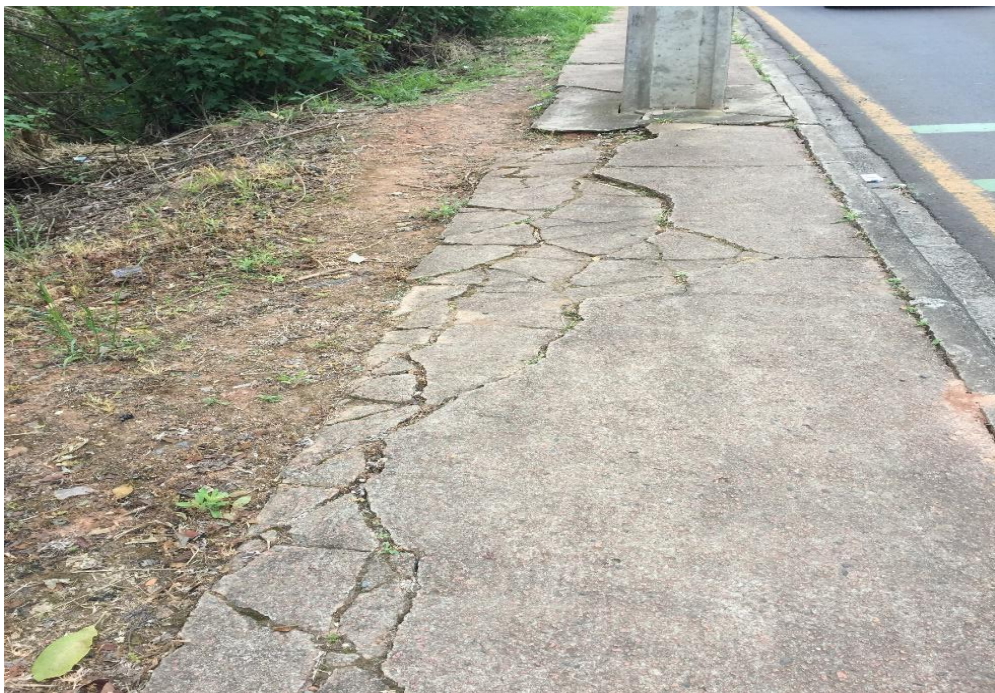
FIGURA 6: Rachaduras na pavimentação da calçada
