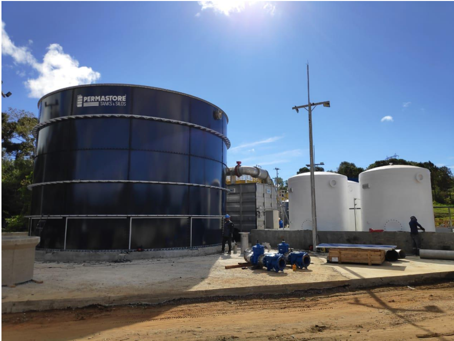
Figura 12 – Vista lateral de um tanque MBBR, à esquerda, não operante, na ETE Verde
