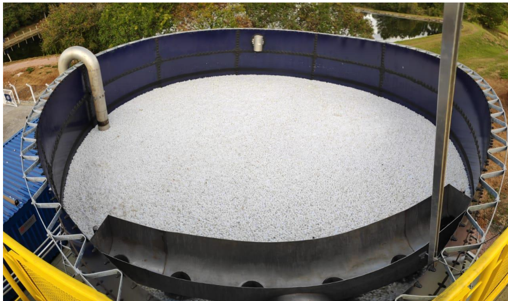
Figura 11 – Vista superior de um tanque MBBR não operante, na ETE Ronda
