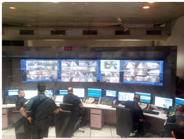
Figura 17 – Sala de comando CCO em funcionamento
