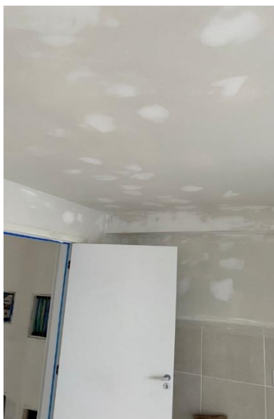
Figura 13 – Marcas de mancha de pintura em paredes e tetos
