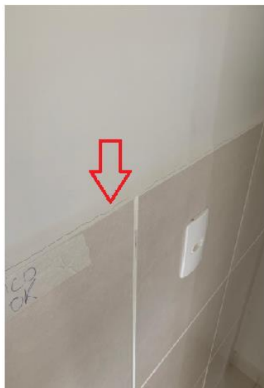
Figura 8 – Cerâmica com sinais de fissuras na parede.
