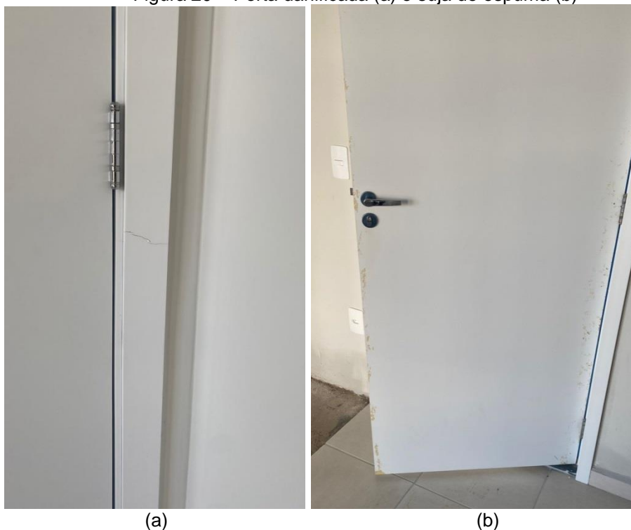
Figura 20 – Porta danificada (a) e suja de espuma (b)
