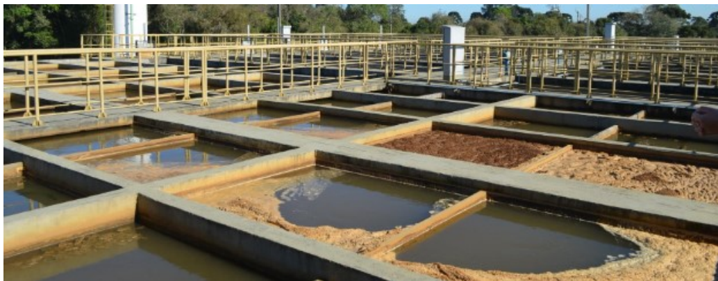
Figura 5 – Tanques de floculação da ETA Miringuava, PR
