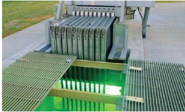
Figura 12 – Tratamento terciário por radiação ultravioleta
