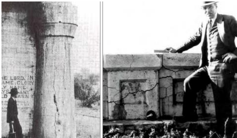
Figura 1 – Estrutura afetada pela RAA
