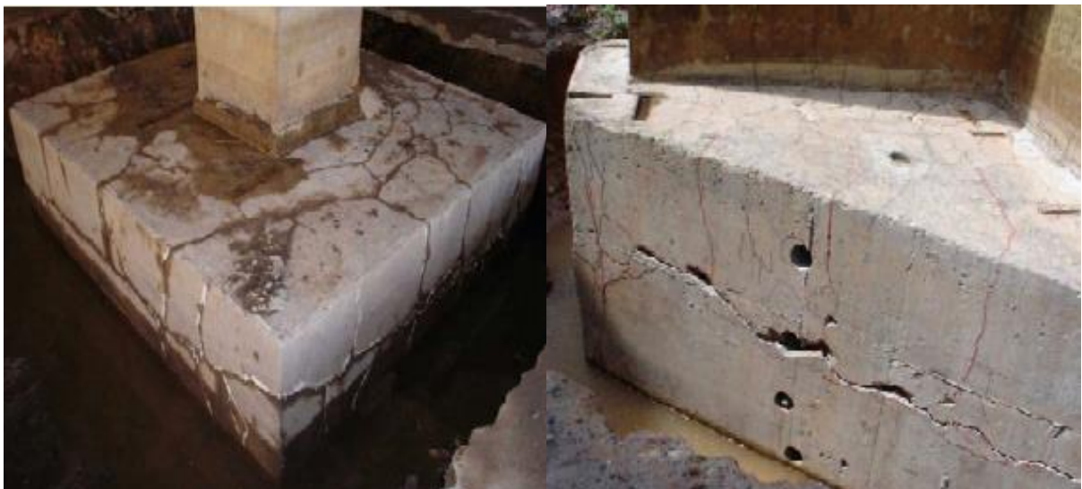
Figura 2 – Fissuração em blocos de fundação afetados pela RAA
