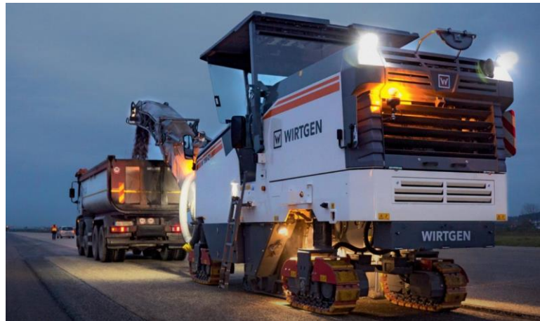
Figura 2 – Processo de fresagem e carregamento do caminhão basculante que irá transportar o material fresado
