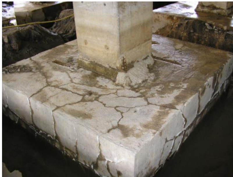
Figura 1 - Bloco de fundação afetado pela reação álcali-agregado.
