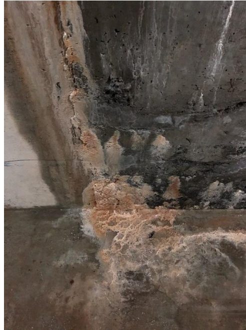
Figura 9 - Estrutura afetada por ISA.
