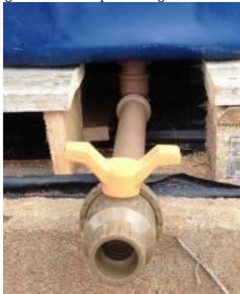
Figura 16: Válvula para drenagem do chorume.
