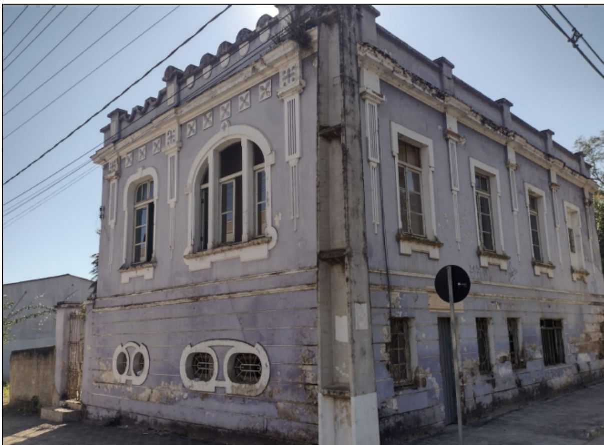
Figura 07: Edificação em deterioração
