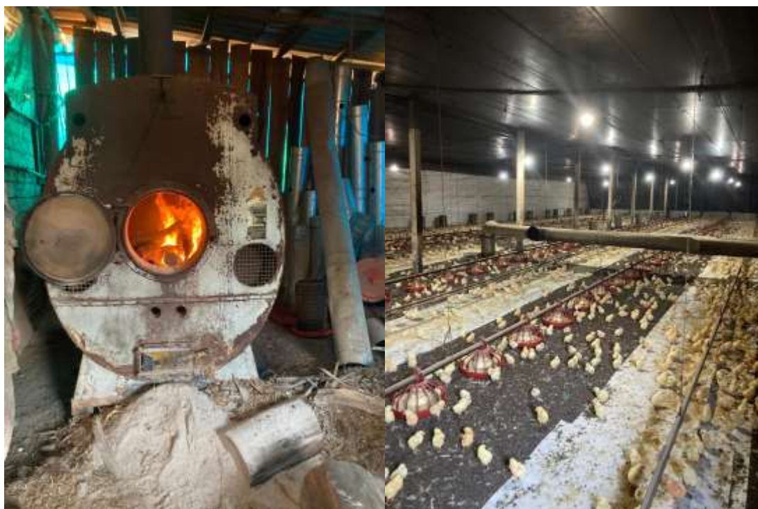
Figura 20 - Sistema de aquecimento de aviários a lenha.
