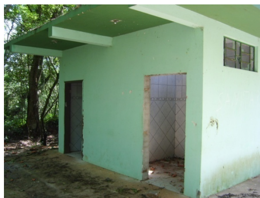
Foto 34. Parque Marguerita Masini (Banheiro depredado). Fonte: VILELA, 2007.
