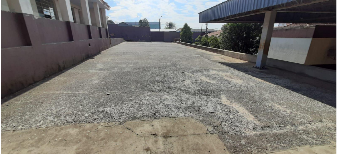
Figura 17 - Calçada externa no colégio, apresentando irregularidades
