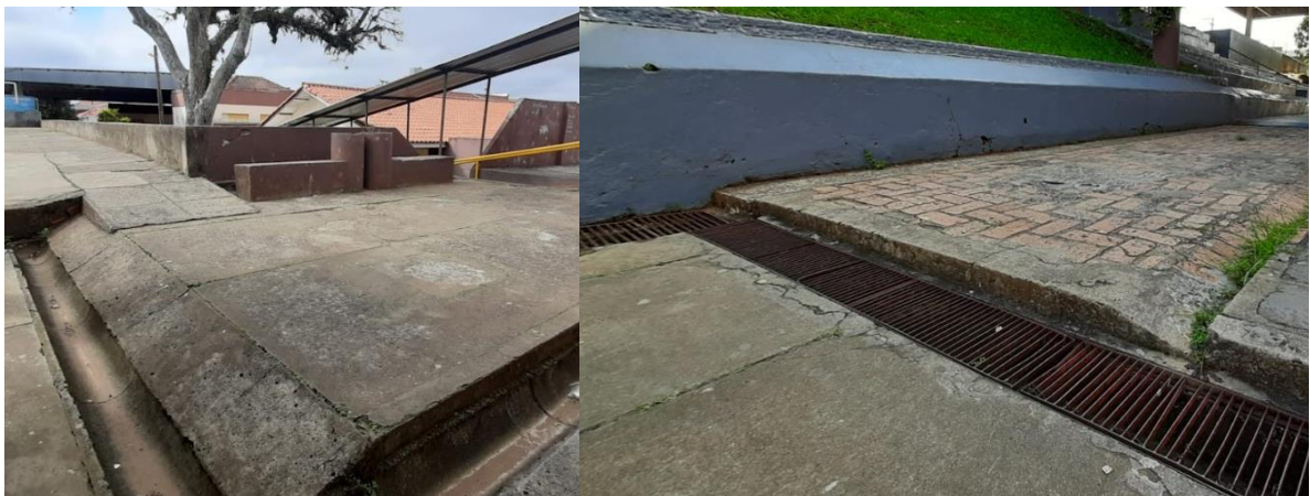
Figura 61 - Canaletas de drenagem pluvial e ralo linear com grelha presente no Colégio Estadual General Osório, respectivamente
