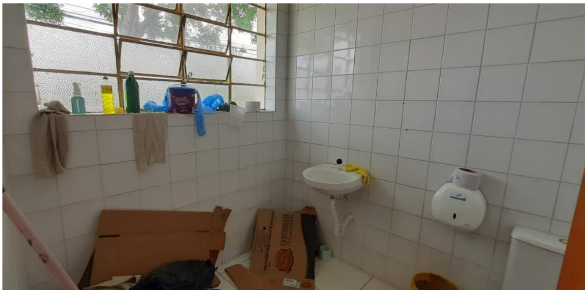
Figura 45 - Cabine do banheiro feminino utilizada como depósito
