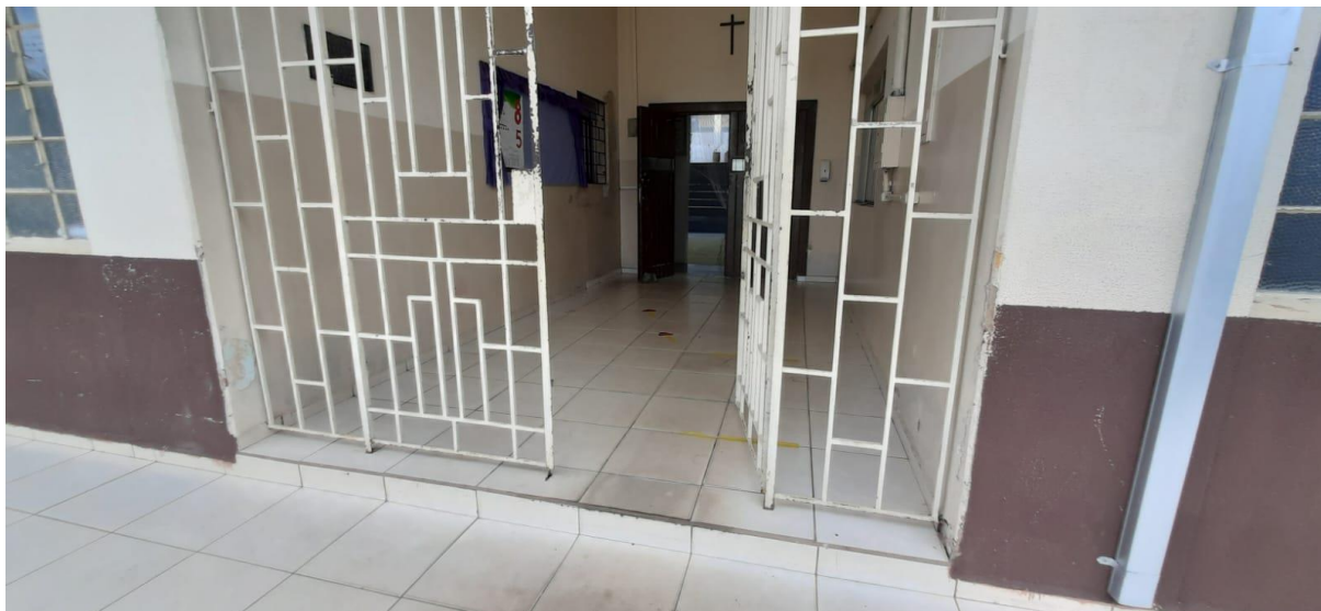
Figura 19 - Degrau no acesso principal do colégio
