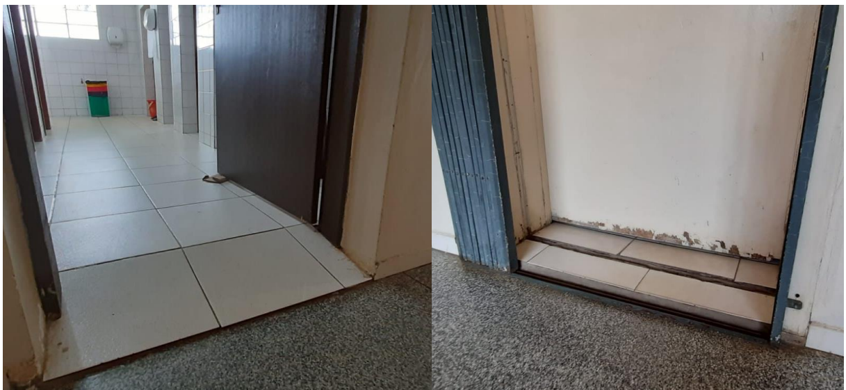
Figura 21 - Exemplo de rampa com inclinação excessiva e de acesso com presença de trilho de chão para porta de correr no bloco de aulas 1
