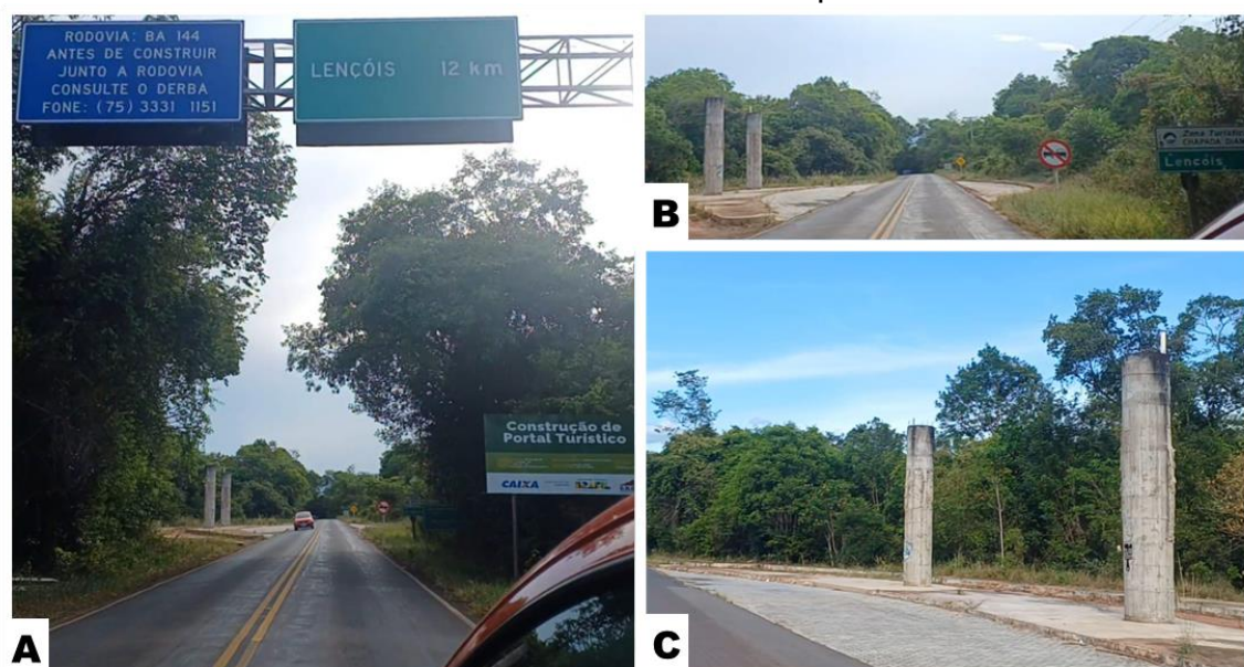
Figura 16 - Obra de pórtico em Lençóis com verba proveniente do Ministério do Turismo. A – Aproximação de onde deveria estar o pórtico; B e C – pilastras construídas e abandonadas do pórtico.
