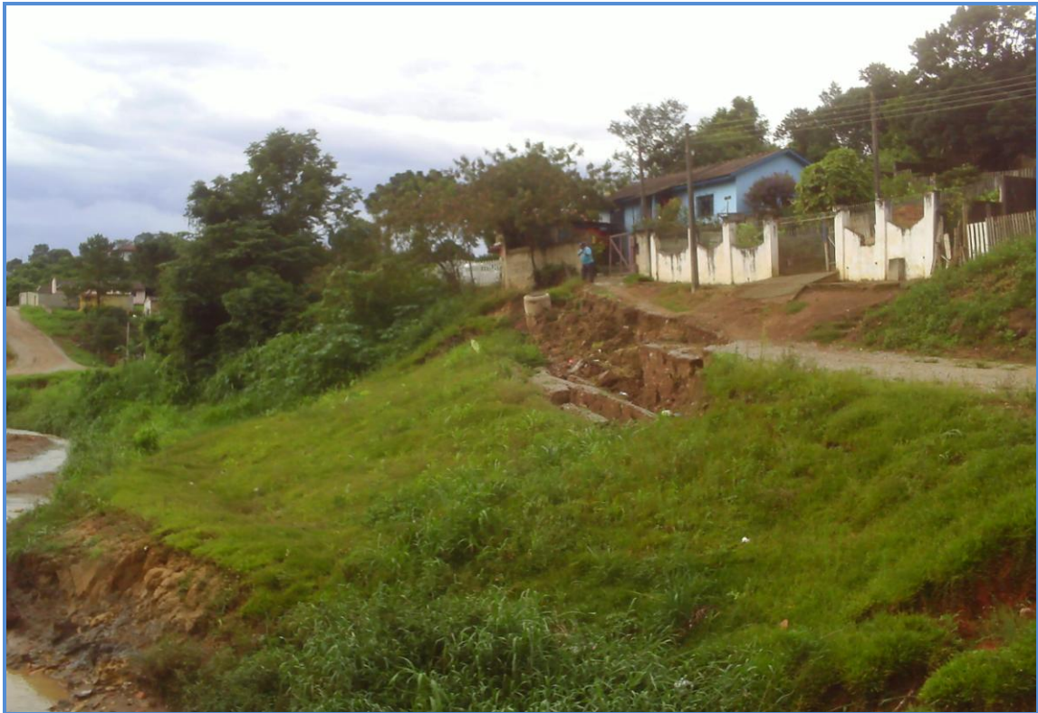
Figura 07 – Desprendimento de Cambissolos Háplicos alumínicos do Arroio Olarias Fonte: O autor Data: 24/01/2011
