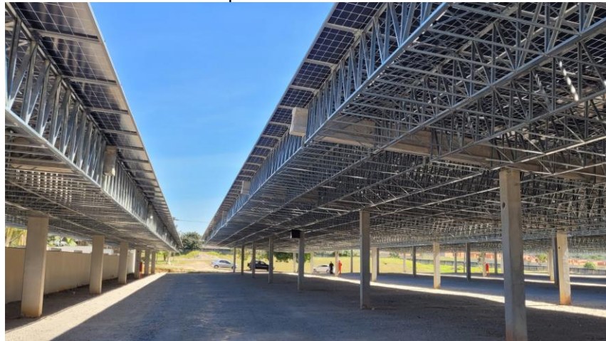
Figura 11 - Usina solar em formato de carport localizada em Sorocaba - SP
