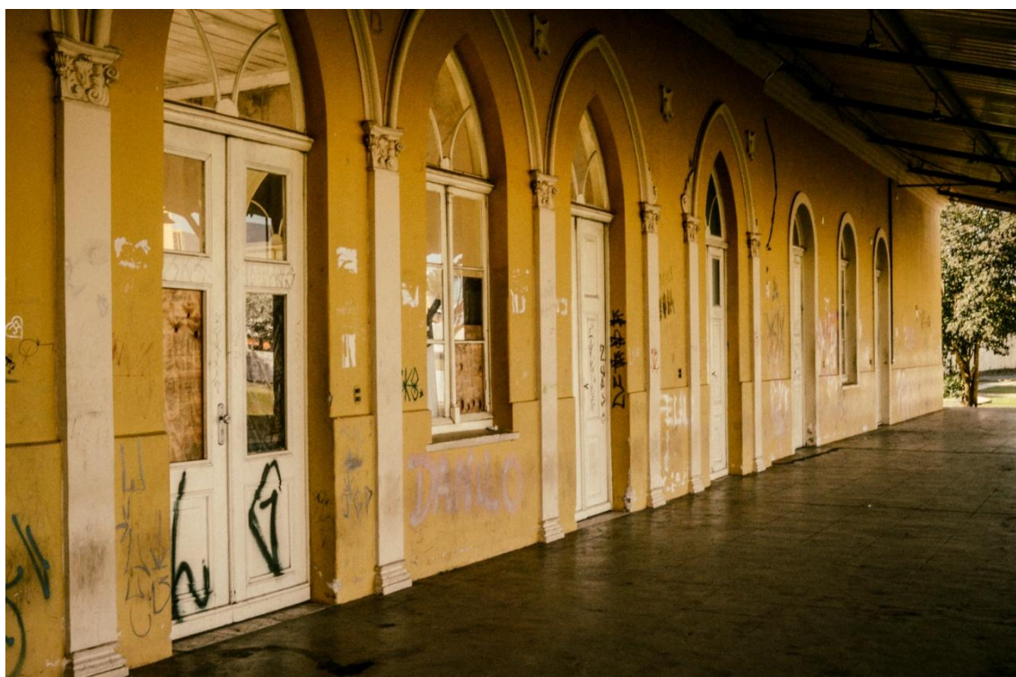
Figura 90: Má conservação da Estação Ponta Grossa.
