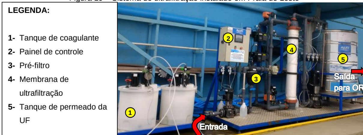
Figura 19 – Sistema de ultrafiltração instalado em Praia de Leste
