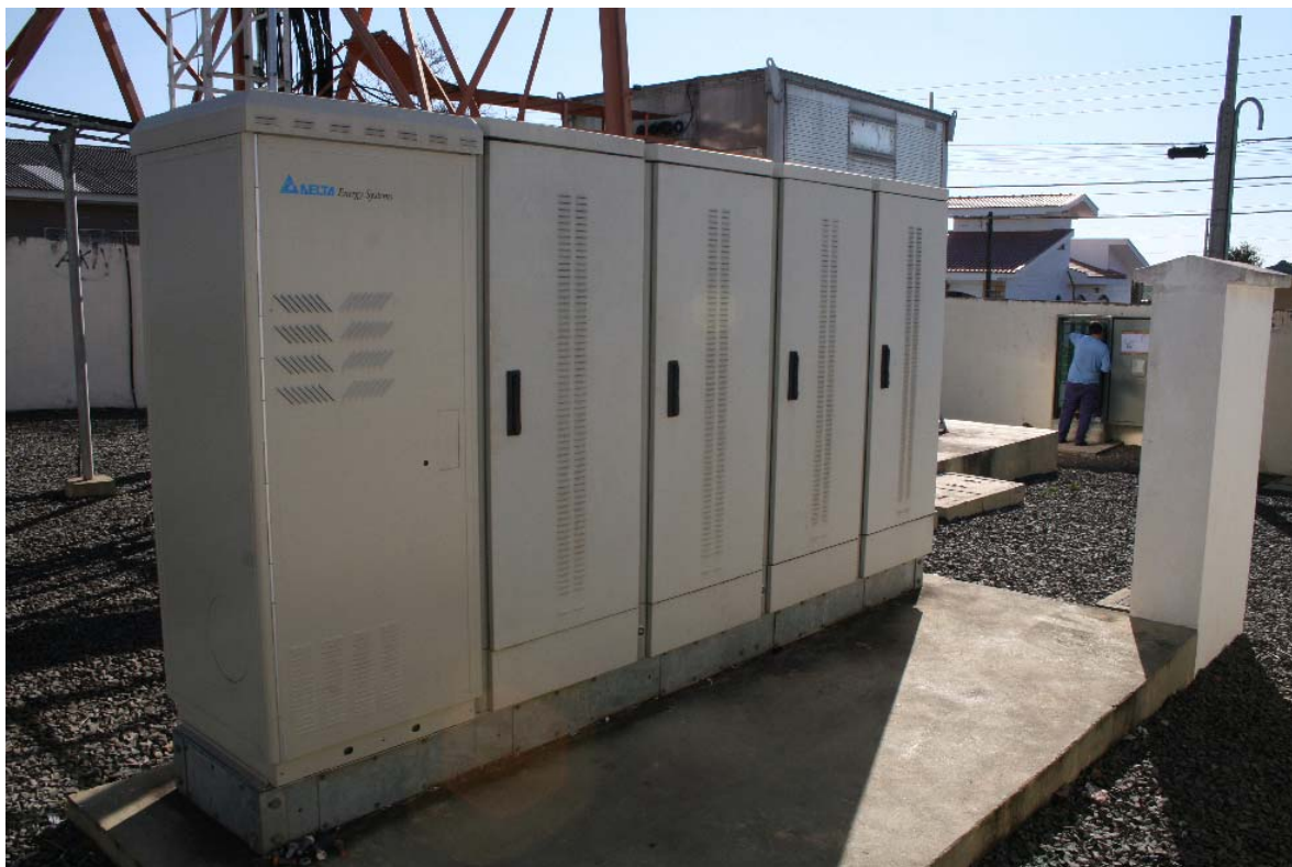
Figura C – Armários de uma Estação Rádio Base, instalados aos pés da torre de suporte das antenas de comunicação. FONTE: Kaczmarech (2009).
