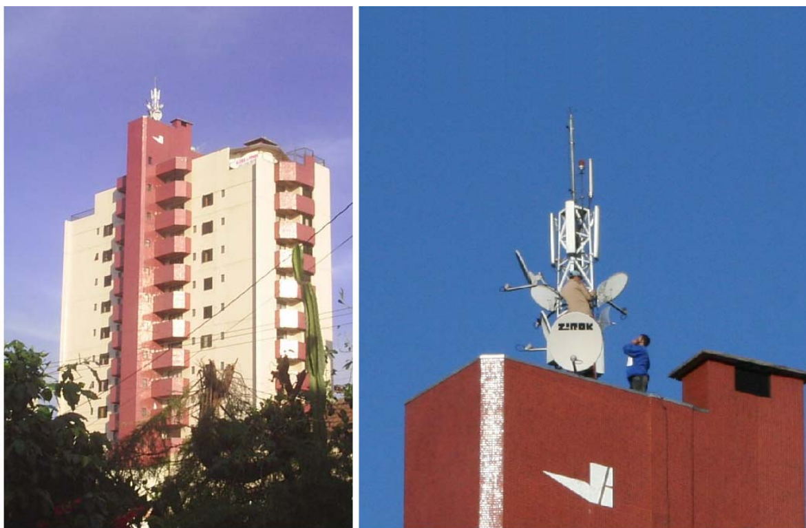
Figura K – Estação de telefonia internet sem fio, instalada sobre a caixa de água de um edifício (Edifício Madrid, no centro de Ponta Grossa). Dois técnicos aparecem fazendo a manutenção da ERB. FONTE: Kaczmarech (2009).
