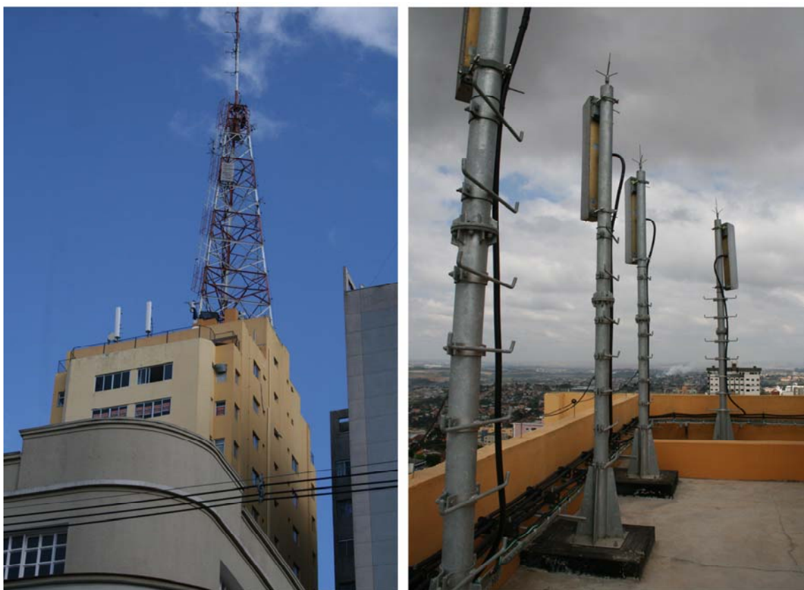
Figura M – ERB de telefonia móvel composta de vários postes que servem de suporte para antenas, instalados sobre a laje de um elevado edifício da cidade (Edifício Residencial Vidal Correia). FONTE: Kaczmarech (2009).
