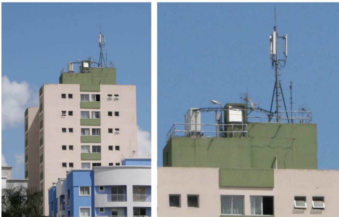
Figura L – ERB de telefonia celular sobre caixa d'água de edifício, mostrando um poste único para sustentar as antenas. FONTE: Kaczmarech (2009).
