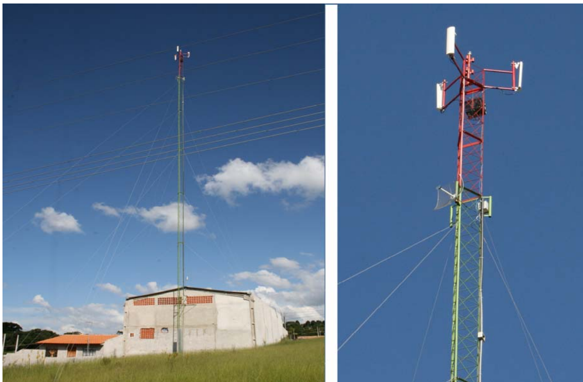
Figura J – Estação de telefonia internet sem fio, mostrando sua torre metálica em treliça, fixada por tirantes. FONTE: Kaczmarech (2009).
