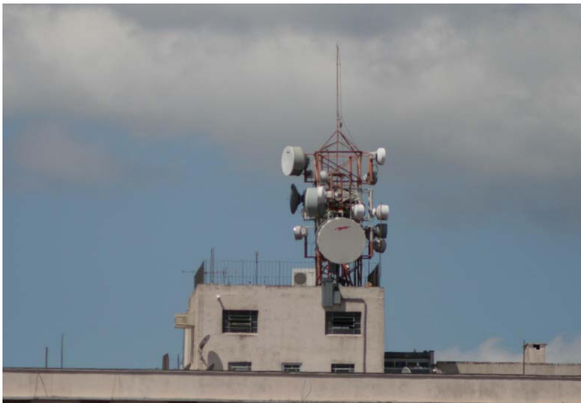
Figura I – Estação de telefonia fixa a distância instalada sobre a caixa de água de um edifício, se destacam suas antenas direcionais, parabólicas. FONTE: Kaczmarech (2009).
