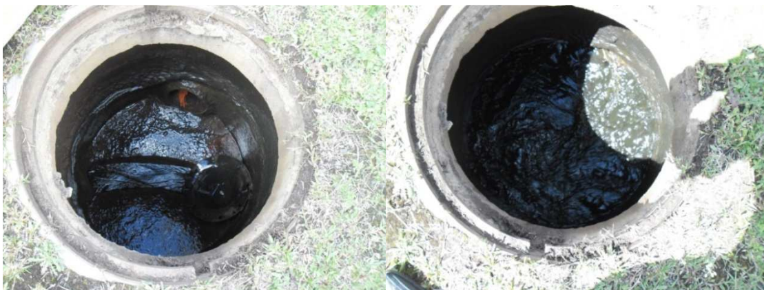
FIGURA 16 – Foto do poço de visita na ETA utilizado para medida de vazão
