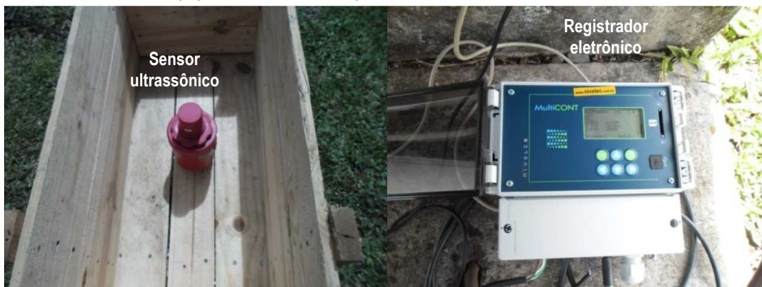
FIGURA 17 – Foto dos equipamentos utilizado para medida de vazão
