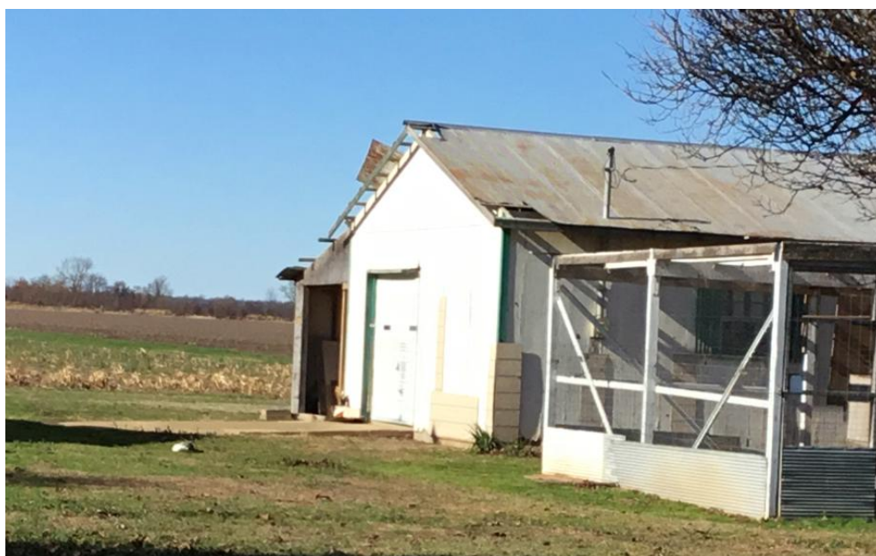
Figura 2.6 - Danos causados por tornado EF0 em 12 de dezembro de 2021 em Harrisburg, Missisipi . Possível verificar a perda de poucas telhas.
