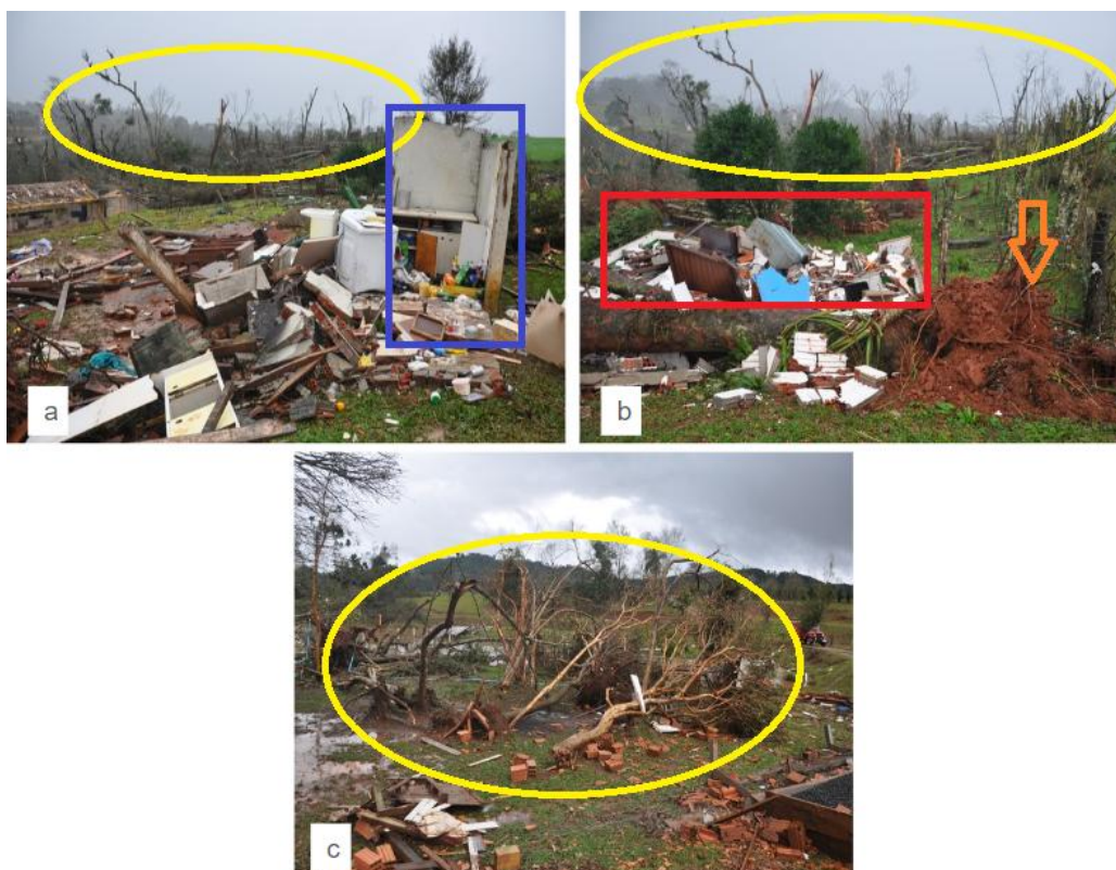
Figura 0.15 - Danos severos causados por tornado no dia 13 de julho de 2015 na área rural de Francisco Beltrão - PR, incluindo destruição de estruturas e árvores arrancadas.
