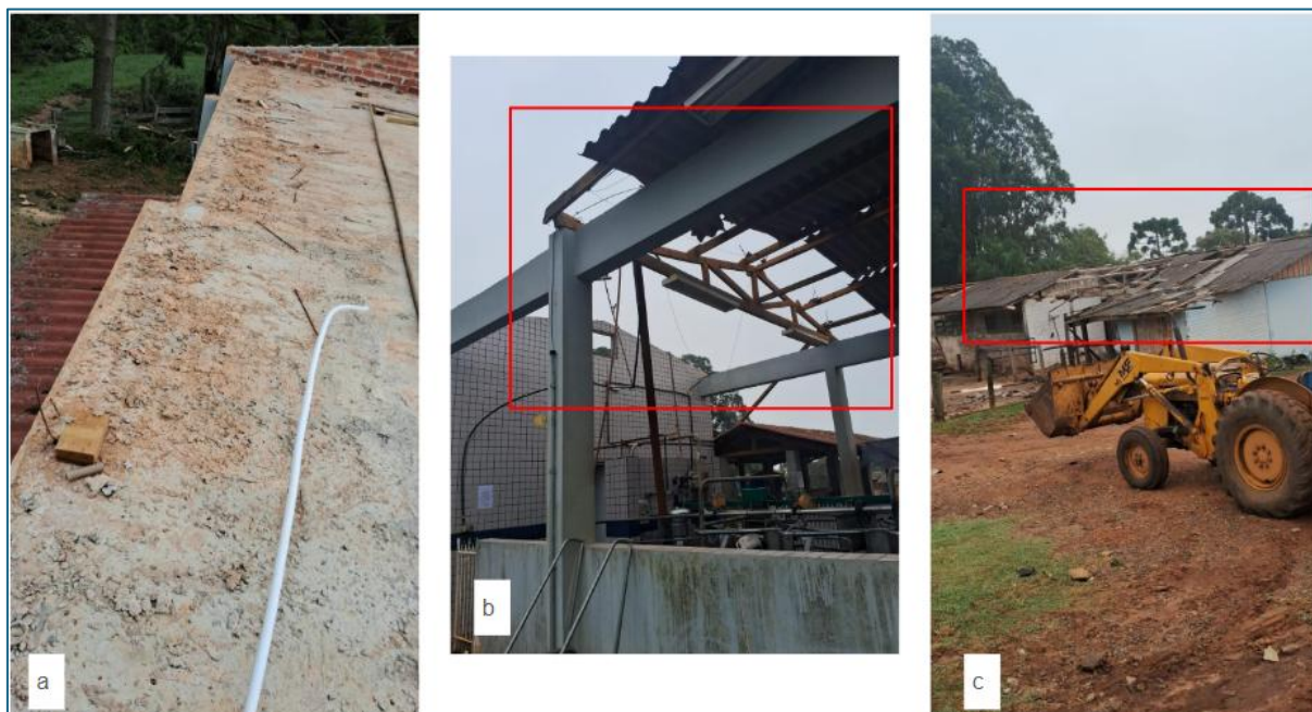
Figura 0.41 Danos causados pelo tornado de 05/04/2024 na fazenda escola da UEPG.
