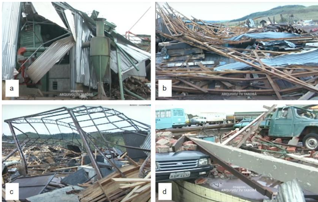
Figura 0.10- Colapso de estruturas industriais ocasionadas pelo tornado em junho de 1997, em Novas Laranjeiras, Paraná.
