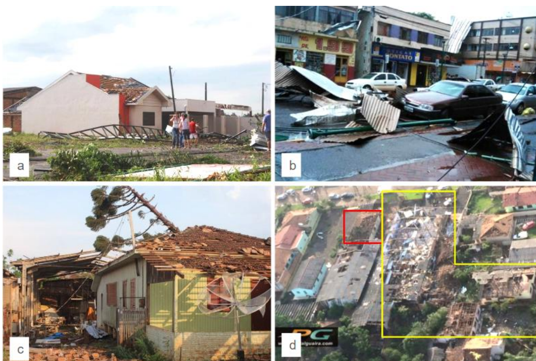
Figura 0.24 - Danos causados por tornado em 15 de novembro de 2015, em estruturas residenciais e comerciais em Marechal Cândido Rondon.
