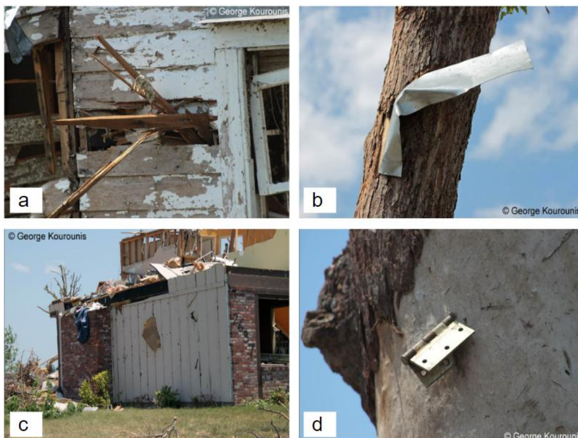
Figura 0.2 - Objetos lançados em forma de "míssil" durante o tornado em Joplin-Missouri em 22 de maio de 2011 - "a" pedaços de madeira transpassam a parede, em "b" chapa de metal cravada em árvore, "c" compensado cravado em parede e em "d" dobradiça cravada em tronco de árvore
