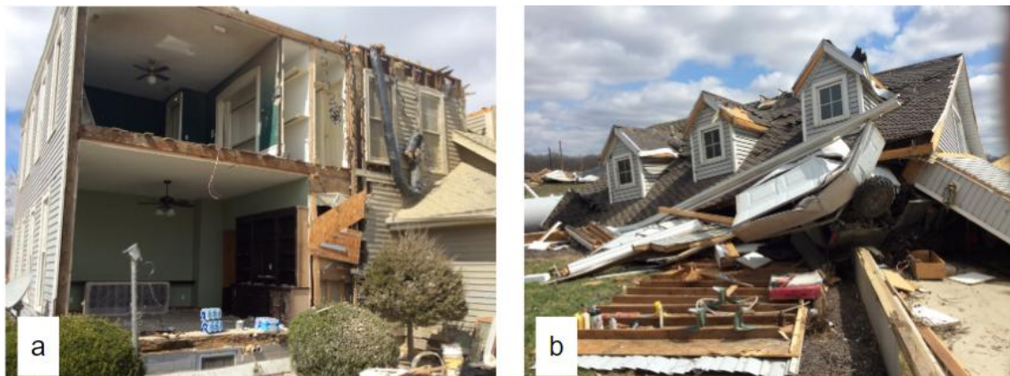
Figura 2.8 - Dano causado por tornado EF 2 no Condado de Fayette/Effingham – Illinois em 3 de abril de 2018. Em “a” perda do telhado e parede externa danificada, em “b” garagem em colapso.
