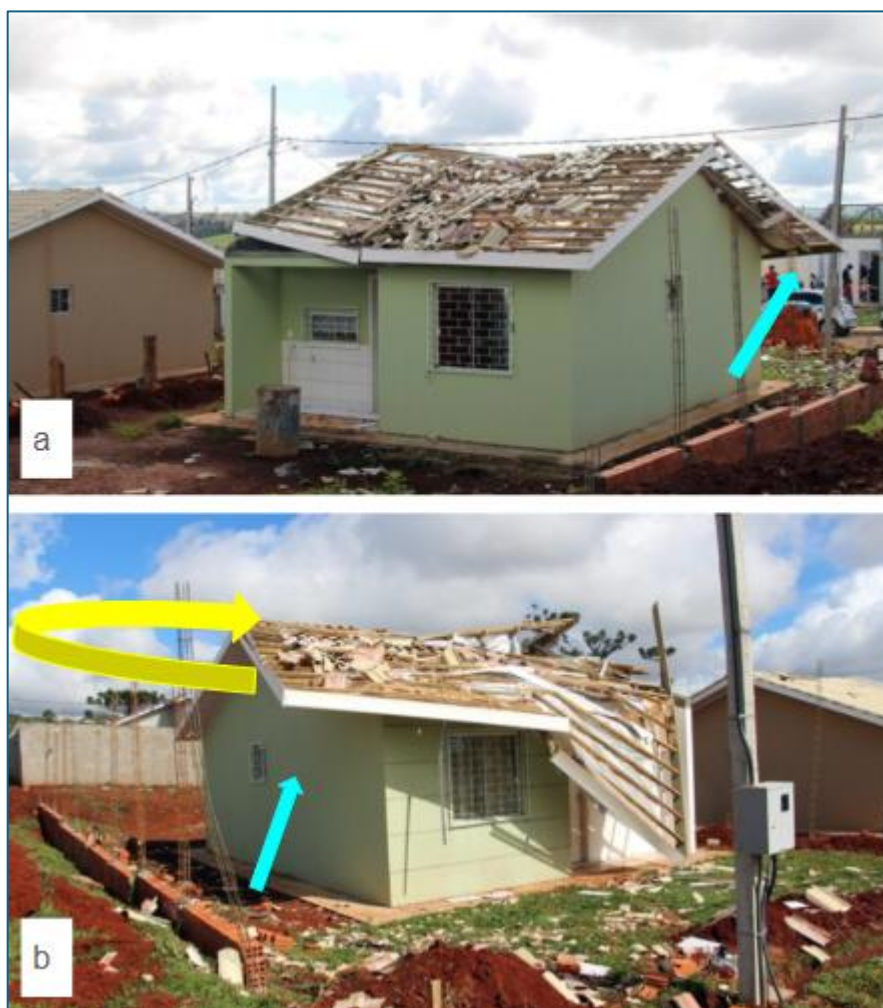
Figura 0.36 - Danos e rotação de telhado em residência localizada no Jardim Amália, Ponta Grossa -PR, em 27/09/2015.
