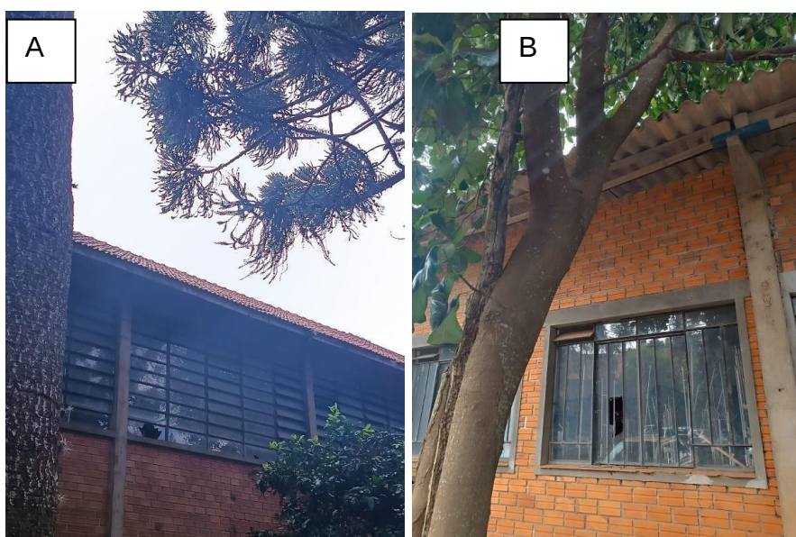
Figura 41 – Vidros quebrados por possíveis galhos que caíram
