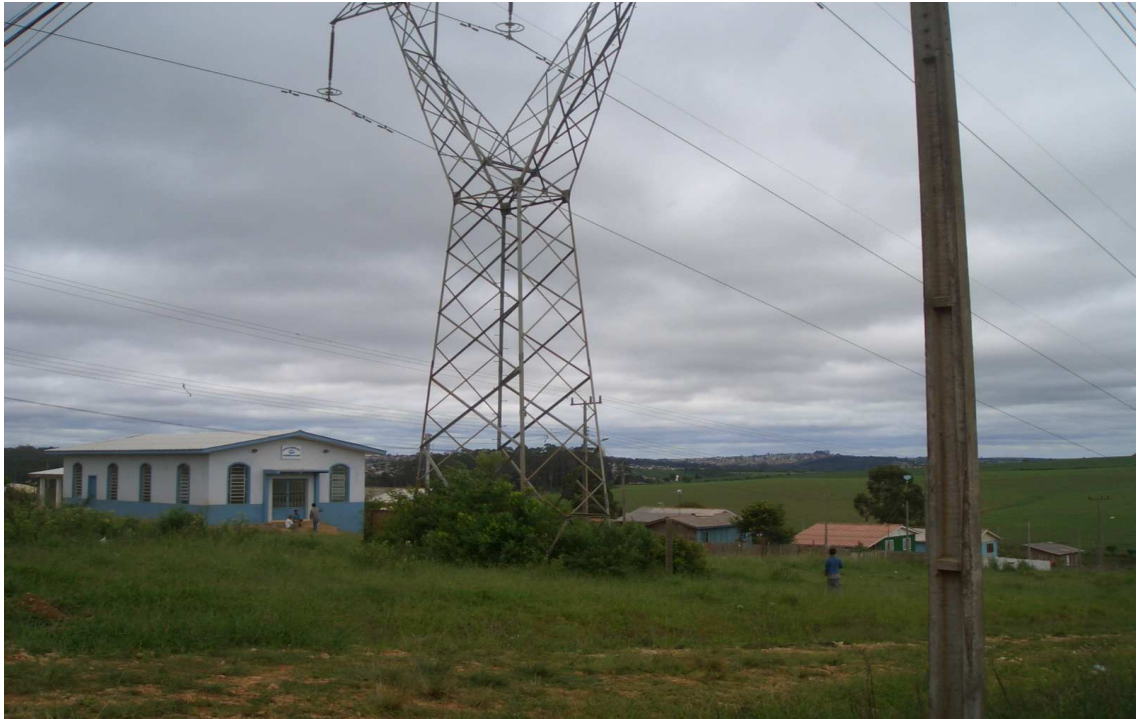
FIGURA 17 – Torre de alta tensão próxima às residências. Fonte: Foto do acervo particular de Virginia de Souza – 24/01/2008.
