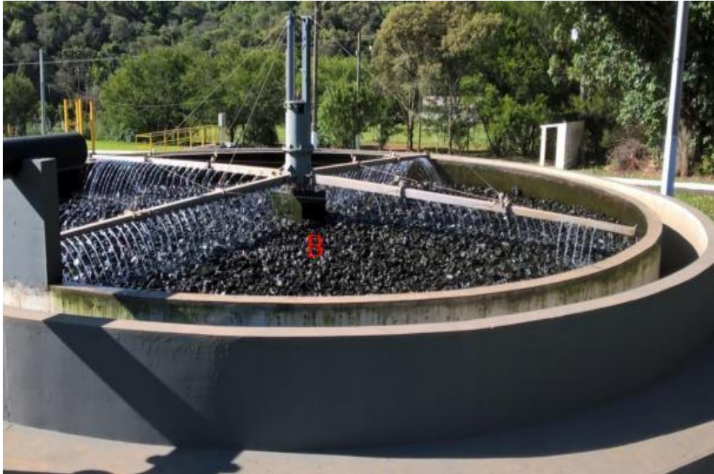
Figura 11 - Filtros biológicos percoladores de fluxo descendente
