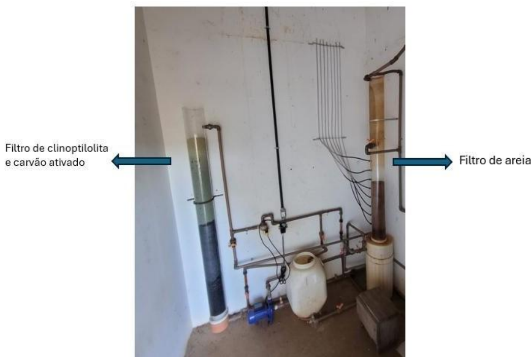
Figura 18 - Disposição dos 2 filtros da filtração lenta
