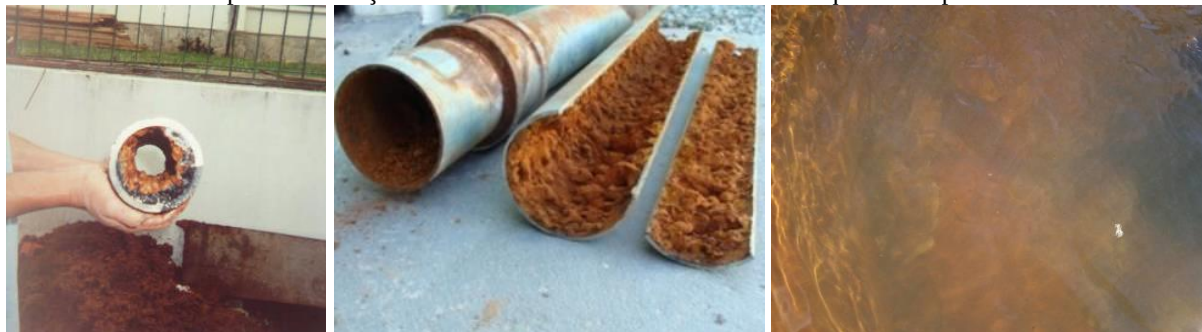
FIGURA 12 – Exemplo de tubulação incrustada e reservatório com material quelado depositado
