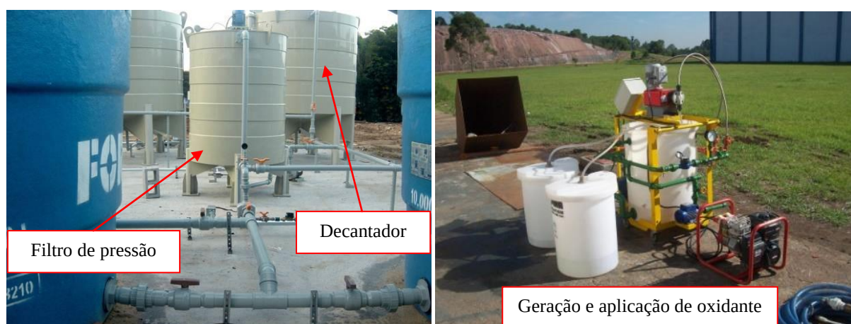
FIGURA 08 – Planta de tratamento por oxidação química e filtros de pressão
