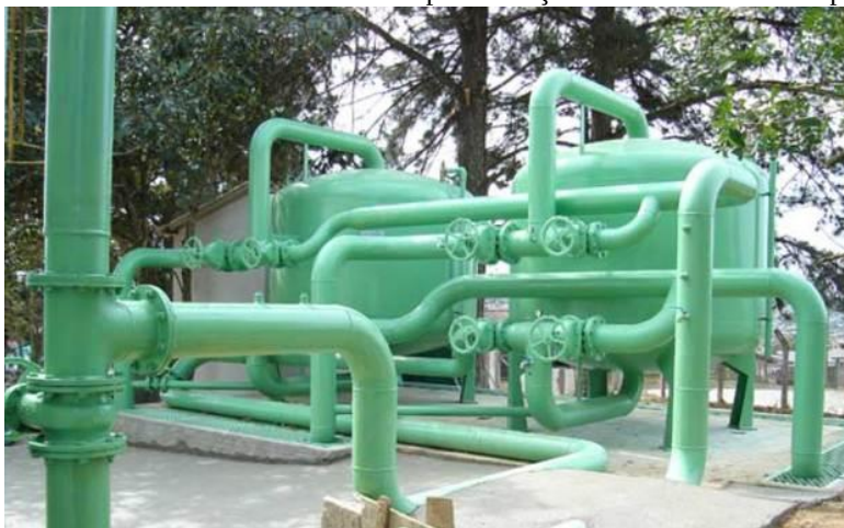
FIGURA 10 – Planta de tratamento por oxidação catalítica e filtros de pressão
