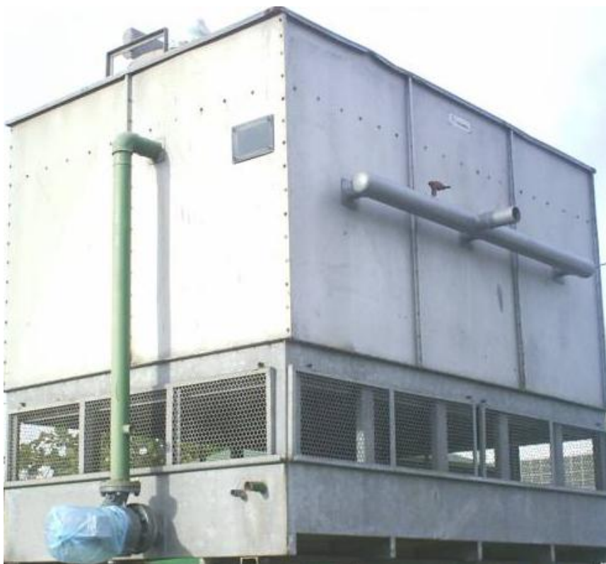
Figura 5 – Torre de resfriamento onde foi realizado o teste para reuso de água
