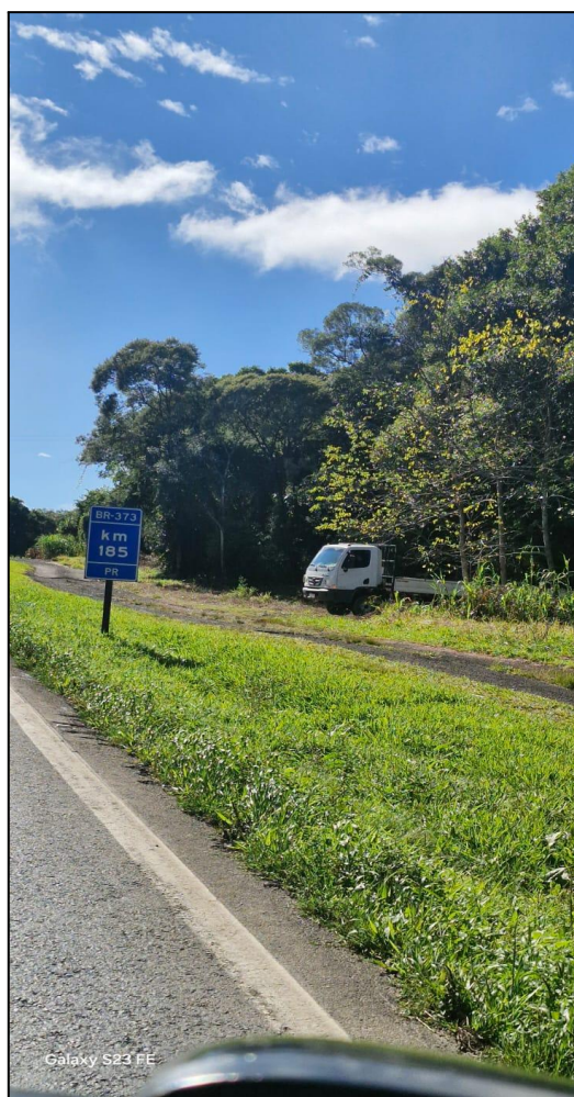
Fotografia 6 - falta de acostamento na pista.
