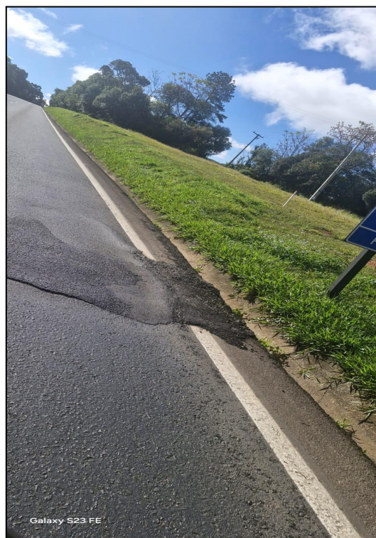
Fotografia 4 - recapeamento irregular da pista.
