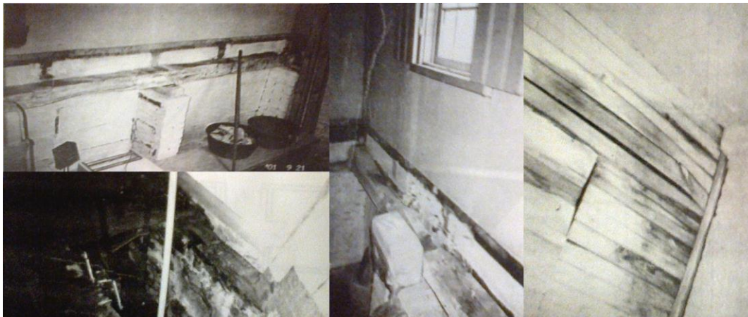
Figura 10: Interior da Casa do Divino antes do processo de restauro.
