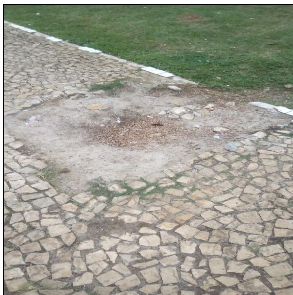
Figura 50- Calçada com sinais de degradação
