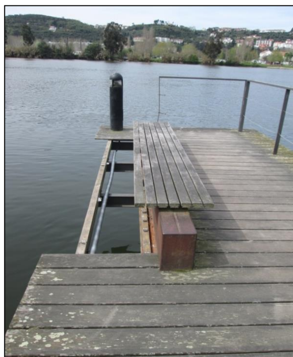
Estado de conservação dos bancos de madeira
