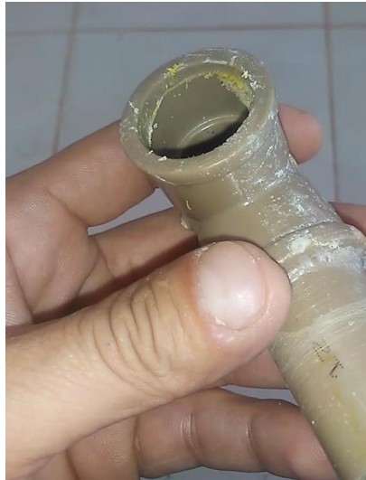
Figura 8 - Joelho solto por falta de cola.
