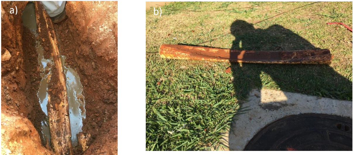
Figura 10 - Esmagamentos das tubulações de esgoto: a) tubulação de esgoto esmagada e b) retirada da tubulação de esgoto esmagada.
