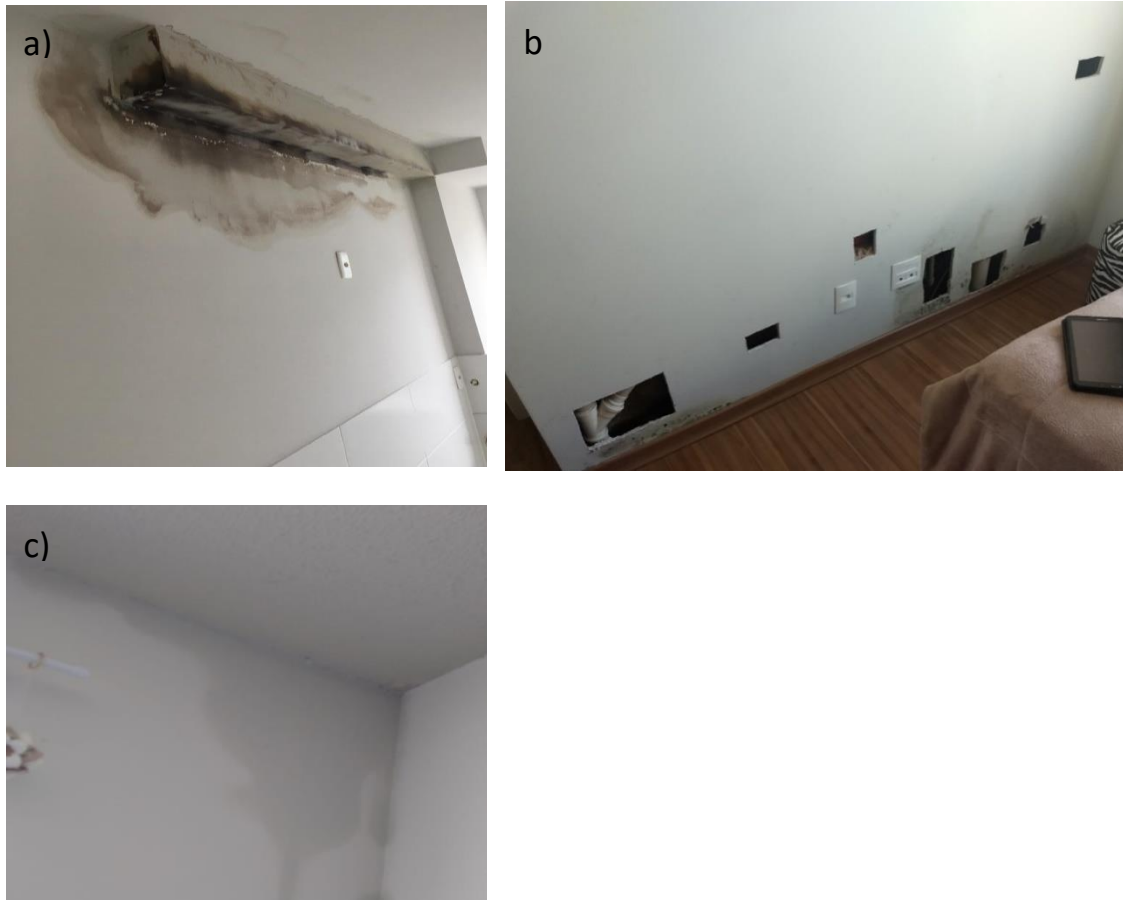
Figura 6 - Infiltrações: a) infiltrações na sanca por conta de vazamentos, b) localização de vazamento após infiltração e c) infiltração ocasionada por vazamento no apartamento superior.
