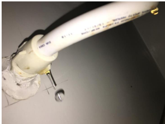
Figura 7 - Engate flexível com vazamento.
