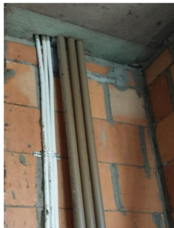
Passagem das tubulações de prumadas
