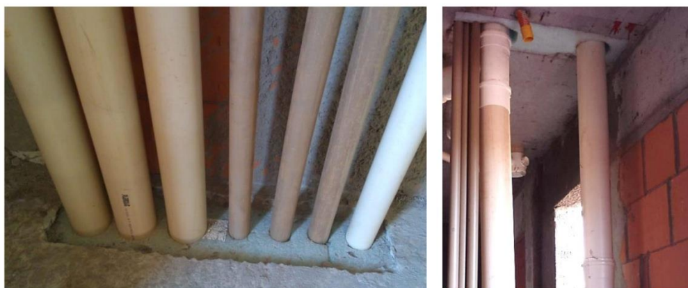
Passagem das tubulações de prumadas
