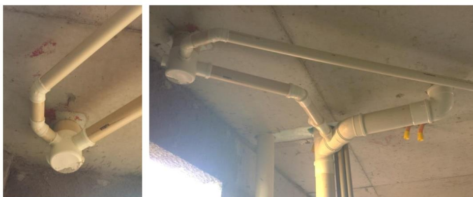
Ramais de esgoto no teto
