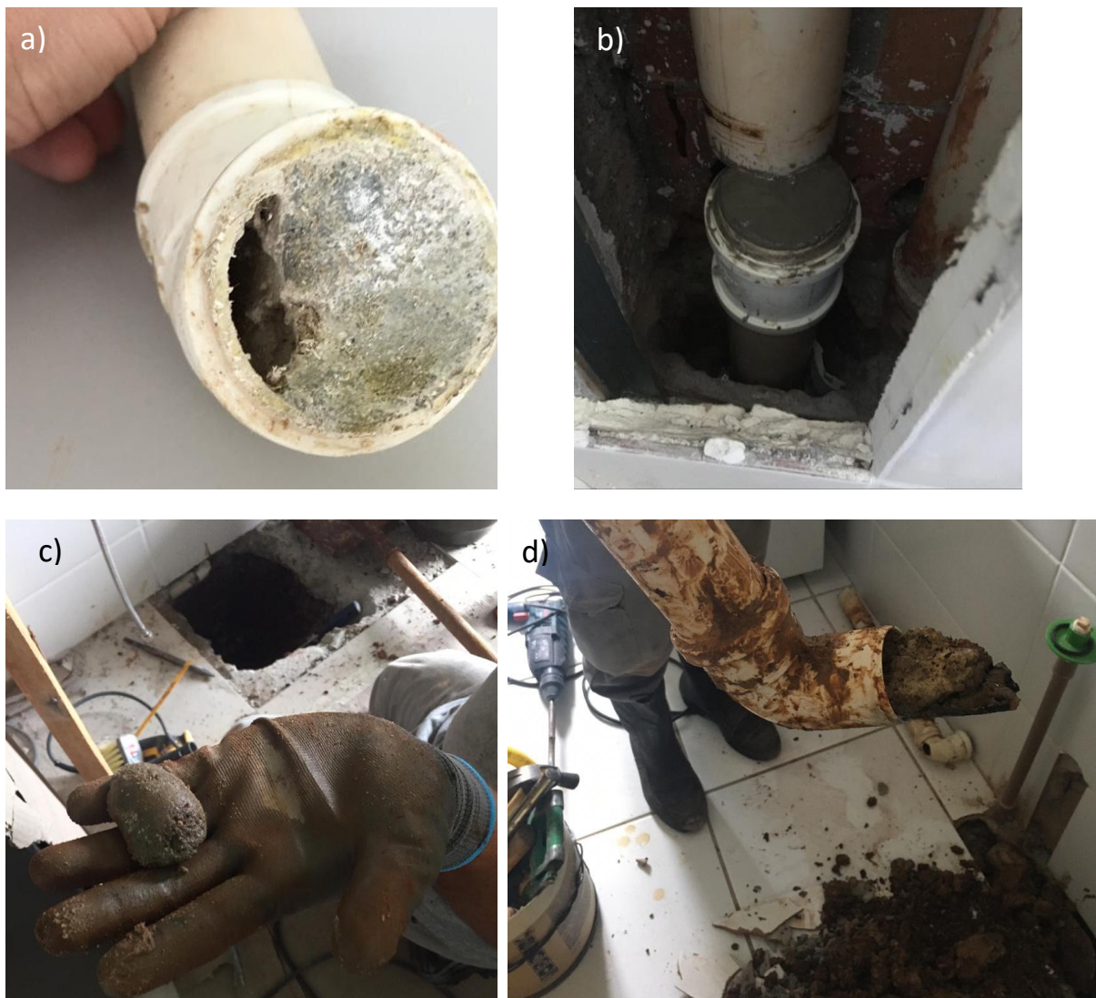
Figura 3 - Tubulações obstruídas: a), b) e c) por argamassa ou graute e d) por luva de equipamento de proteção individual.
