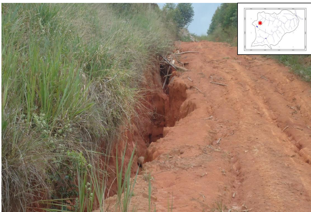
Figura 12. Processo erosivo em estrada localizada na Bacia do Arroio Uvaranal, Telêmaco Borba – PR Autor: Bahr (2011)
