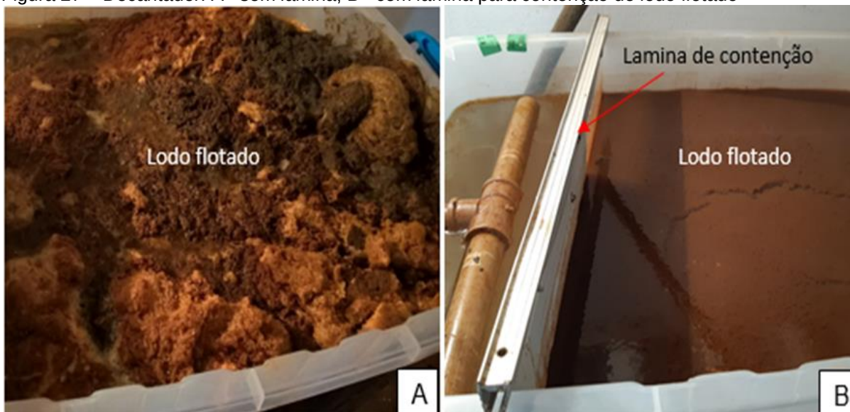
Figura 27 – Decantador. A= sem lamina; B= com lamina para contenção de lodo flotado
