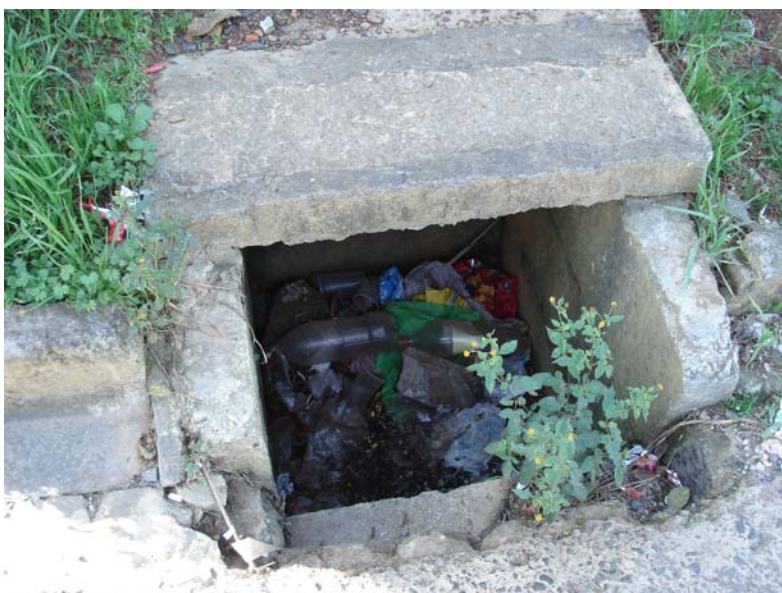
Figura 10: Boca-de-lobo entupida por lixo - Arroio Olarias.
