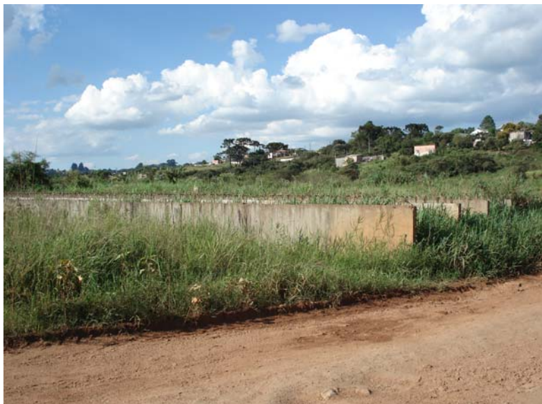
Figura 8: Obras abandonadas da barragem em área do Arroio Olarias
