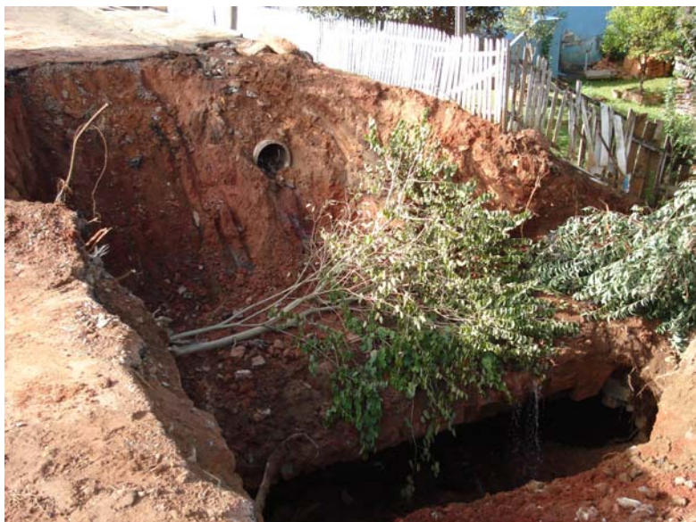
Figura 24: Desmoronamento da rua em trecho acima do Arroio Madureira canalizado por ocasião da via pública.
