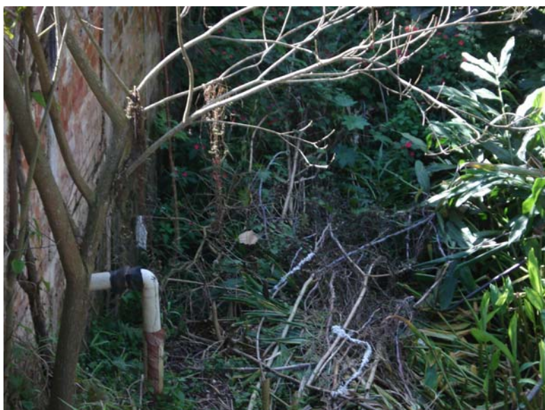
Figura 9: Esgoto irregularmente lançado em afluente do Arroio Olarias.
