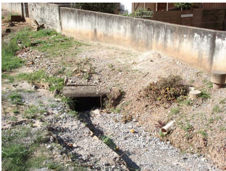
Figura 11: Boca-de-lobo em via pública não pavimentada – Arroio Olarias.
