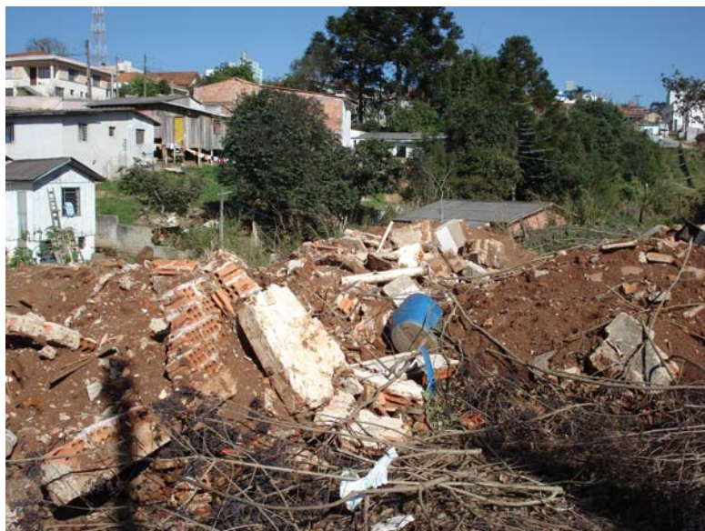
Figura 28: Entulhos de resíduos da construção civil em área que corresponderia ao segundo trecho do parque. Fonte: Trabalho de campo, 2009.
