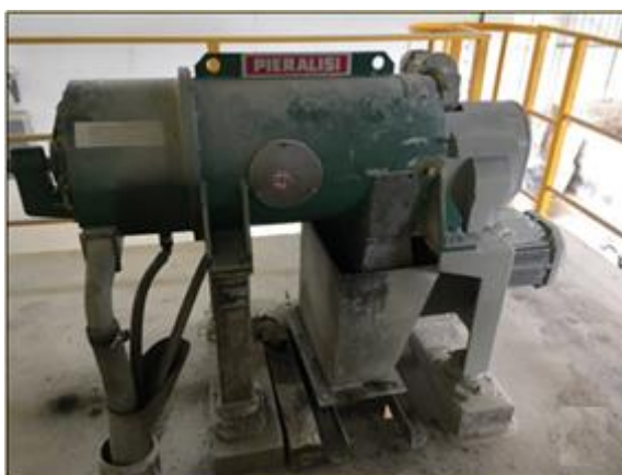
FOTOGRAFIA 5 -Centrífuga do tipo decanter (ETE Verde/Ponta Grossa/Brasil)
