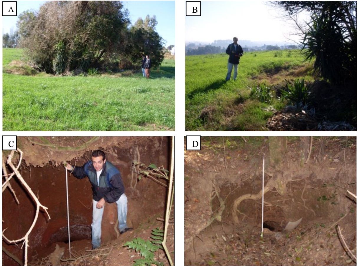
Figura 21 – Fotos de Capão de mata onde havia piping associado a colapsos
