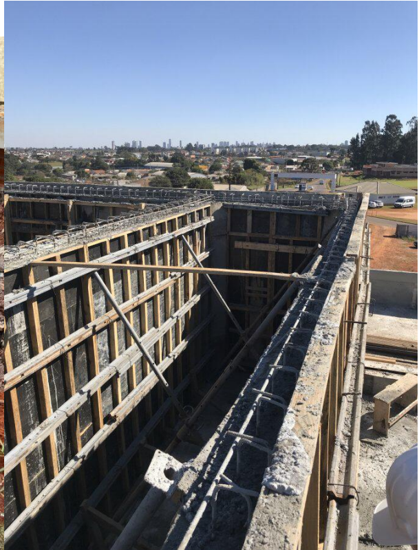
Figura 30- Reservatório de água cinza pluvial tratada
