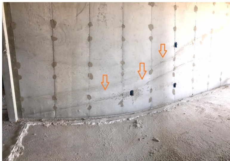
Figura 44- Fissura em junta fria
