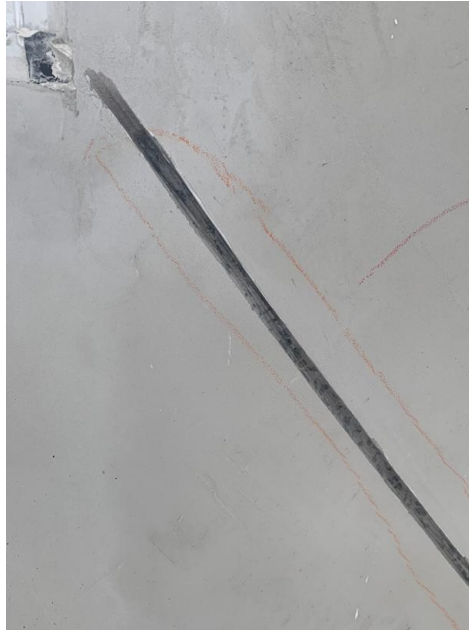
Figura 50- Abertura na fissura ativa
