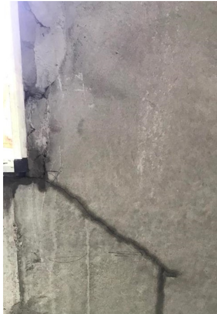
Figura 55- Umidade na região
