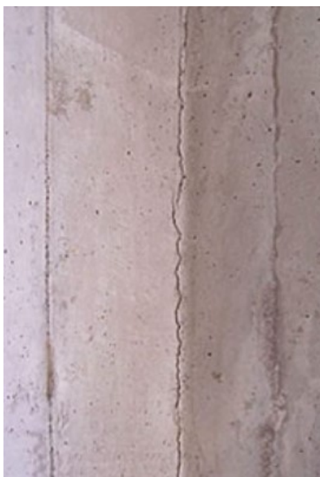
Figura 30- Fissura em parede de concreto
