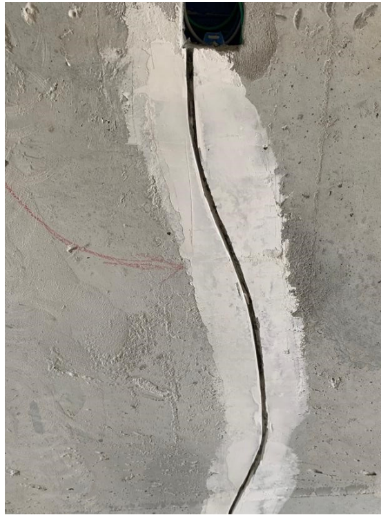
Figura 57- Abertura de fissura passiva
