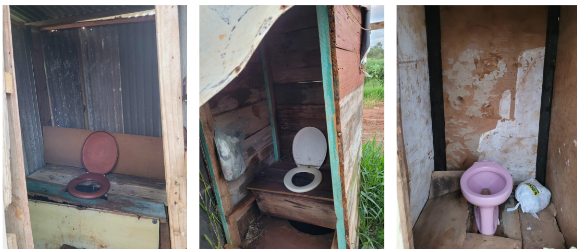
Fotografia 5 - Latrinas situadas nas esquinas da Ocupação Andorinhas, construídas pelos moradores diante da ausência de banheiros e saneamento básico
