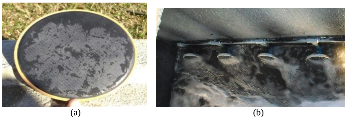
Figura 5.3 – Difusor de microbolha instalado no fundo do tanque de aeração: a) difusor tipo prato, b) difusores em funcionamento espaçados 15,0 cm entre si e a 1,0 m de profundidade
