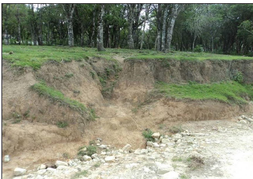
FIGURA 24 – Processo erosivos no criadouro comunitário
