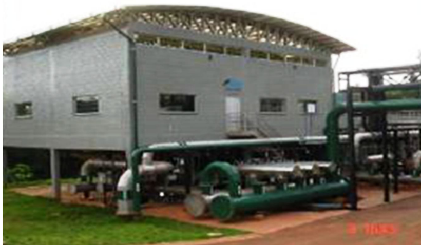
Figura 3.3 - Vista da planta de ultrafiltração
