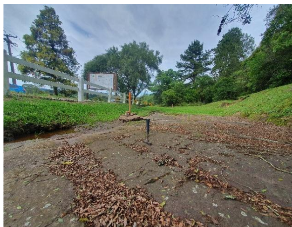
Fotografia 7 – Acúmulo de água pluvial nas margens do pavimento estriado, demonstra falta de disciplinamento da drenagem das águas pluviais
