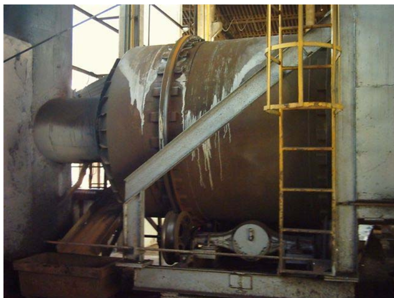
Figura 1.2 Lateral do forno rotativo. Detalhe mostrando o sistema de exaustão dos gases de combustão na traseira do forno.
