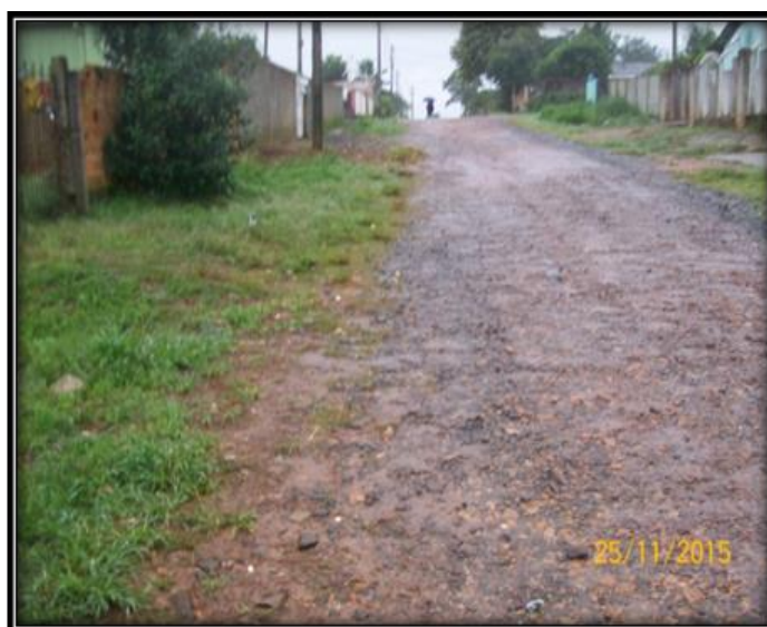
Foto 31 - Rua Hara na Vila Santa Mônica – falta de pavimentação e meio fio dificulta a orientação para os cegos
