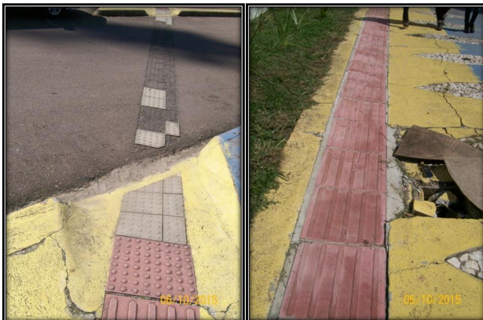
Fotos 51 e 52 – Pista tátil deteriorada e com buracos no entorno do ginásio Jamal Farjallah Bazzi
