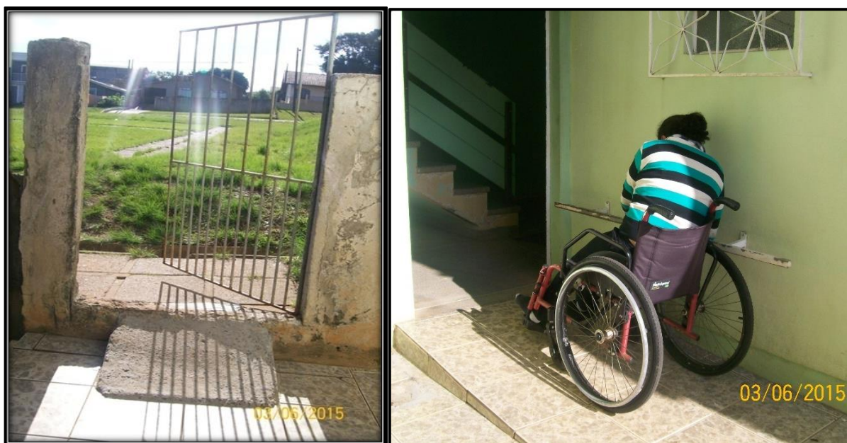
Fotos 12 e 13 - Moradia com rampas fora das especificações dificultando a autonomia de deslocamento de cadeirantes
