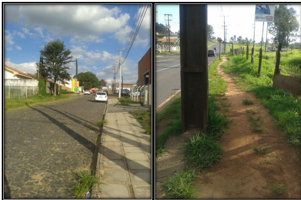
Fotos 25 e 26 – Rua Fidélis Augusto Alves e Avenida Monteiro Lobato na Vila Baraúna – calçadas inadequadas e inseguras
