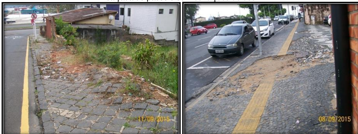
Fotos 34 e 35 – Rua Sete de Setembro e da Avenida Balduino Taques – calçada do passeio sem condições de uso
