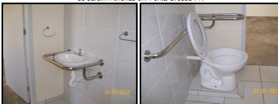
Fotos 13 e 14 - Barras de segurança no banheiro das casas adaptadas do Jardim Athenas em Ponta Grossa-PR
